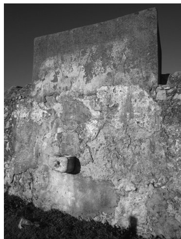
Fig. 18. Mosteiro de S. Bento de Cástris. Aqueduto. Ponto de abastecimento de água e caixa
