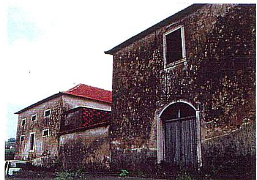
Fig. 25 - Quinta do Vimeiro, vista do alçado orientado a Noroeste, do edifício A .
