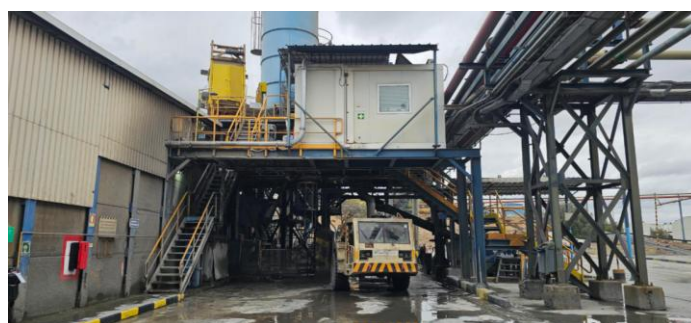
Figura 4.10 - Instalação para produção de betão na Somincor (Central ARCEN).
