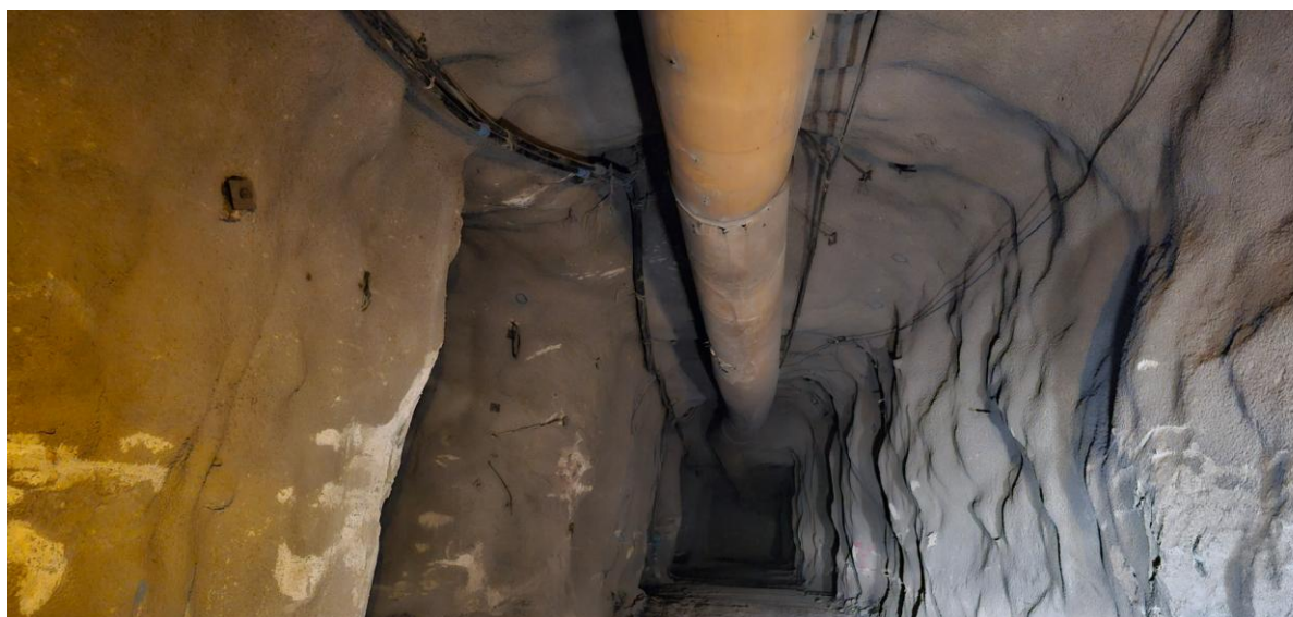
Figura 5.17 - Imagem de galeria subterrânea onde foi utilizado o revestimento com betão projetado.
