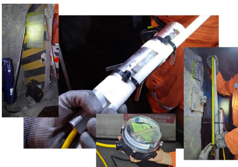
Figura 5.33 - Imagem de geofone e pormenores do dispositivo de transmissão de dados, varas de instalação e tubo de respiro.
