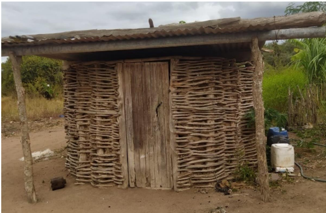
Figura 2-13: Construção do tipo pau-a-pique existente na localidade de Goane 1, no Distrito de Moamba. Fonte: Autora, 2023.
