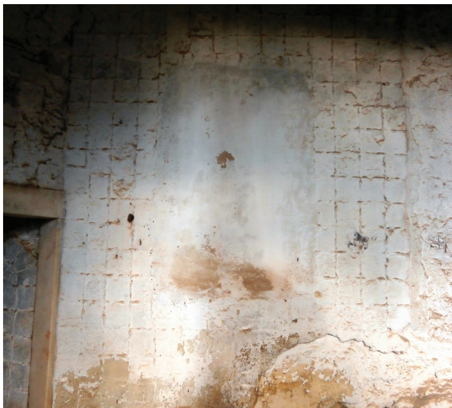
Figura 5.12 - Espaço vazio e negativos deixados pelo arranque dos azulejos do painel dos Cardins (ao centro) e limítrofes. Dezembro de 2018.
