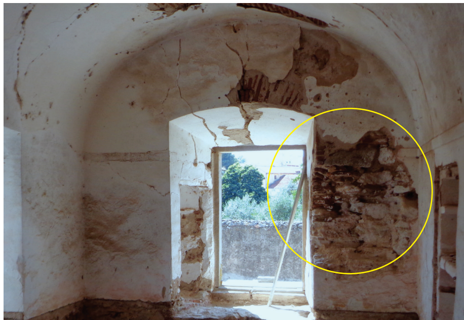
Figura 6.50 - Aposentos das madres prioresas, no segundo piso da torre. Negativo deixado pelo arranque de pia ou lavatório em pedra, provido de descarga de águas sujas. Julho de 2018.
