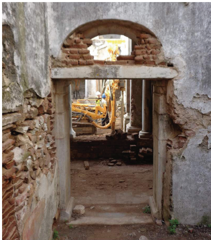
Figura 5.21 - Porta da Casa das Escadas - Lado de dentro (norte), antes da remoção da verga. Abril de 2018.
