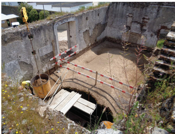
Figura 5.23 - Casa da Enfermaria, no primeiro piso, na altura em que já se tinha levantado o que restava do pavimento e se procedia à reparação da abóbada da Casa do Capítulo, sobre a qual se sobrepõe. Maio de 2018.
