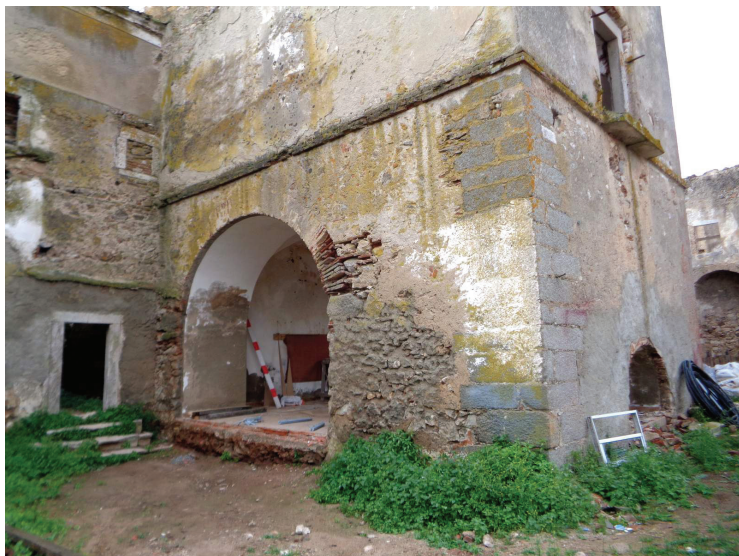
Figura 6.13 - Alçado norte do piso térreo da Torre da Prioresa, já com o arco estrutural N aberto e vendo-se claramente o cunhal do canto NO. Junho de 2018.
