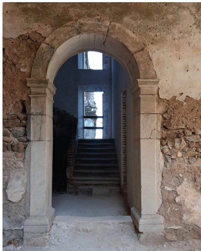
Figura 5.22 - Porta da Casa das Escadas - Lado de fora (sul), depois da remoção da verga interior. Novembro de 2020.
