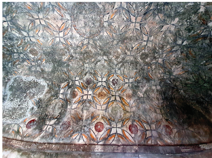
Figura 6.17 - Aspecto da decoração da abóbada de berço do segundo piso da Torre da Priorosa. Novembro de 2020.
