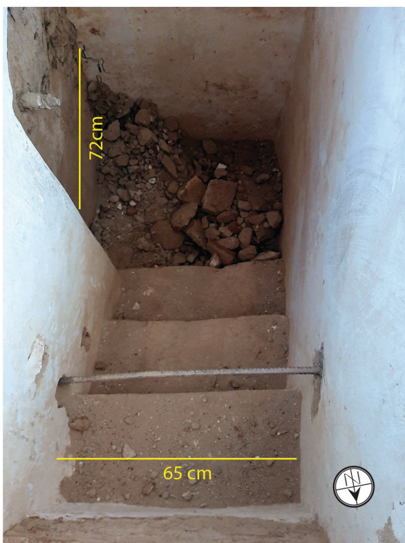
Figura 6.28 - Lance de escadas mais antigo, que se encontrou oculto sob o pavimento da buraca do arranque das escadas do 2.ª para o 3.ª piso da Torre da Prioresa. O vão de porta entaipado está assinalado com a sua largura, 72cm. Dezembro de 2021.
