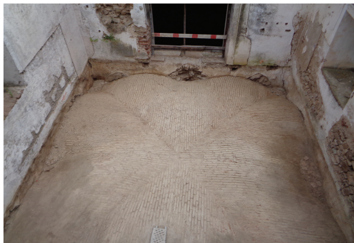
Figura 6.37 - Casa do Coro Alto vendo-se, depois de limpo, o extradorso da abóbada do Coro Baixo. Em volta pode-se observar o prolongamento dos rebocos caídos para lá da linha do pavimento. Junho de 2018.
