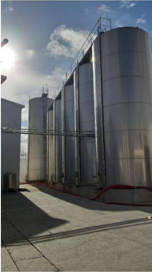
Fig. 33 – Cubas em inox localizadas no exterior do edifício. (Foto do autor. 6 de novembro, 2019).
