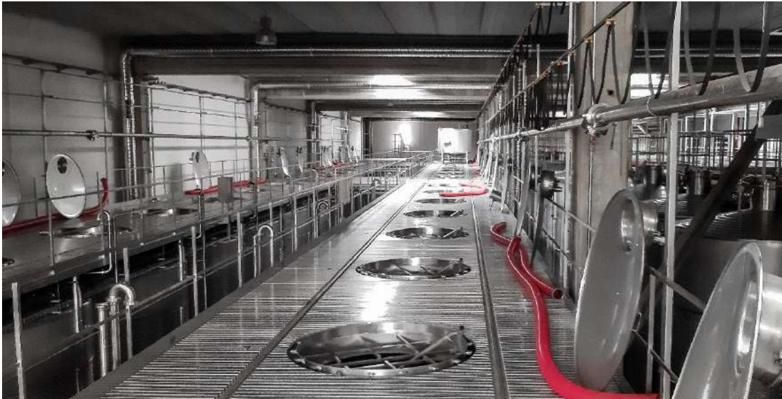
Fig. 54 – Alinhamento de cubas ao longo do edifício. (Foto do autor. 6 de novembro, 2019).
