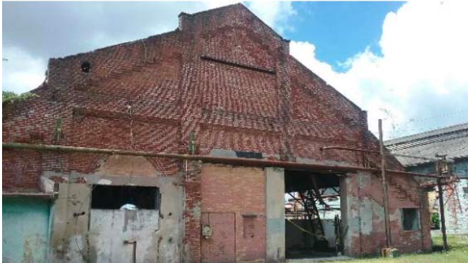
Fig. 21 Bâtiment des machines et des générateurs Source : Archive de Teresa Bilbao
