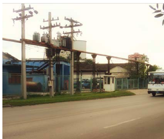
Fig. 6 Infrastructure électrique Source : Archive d'Isell Guerrero
