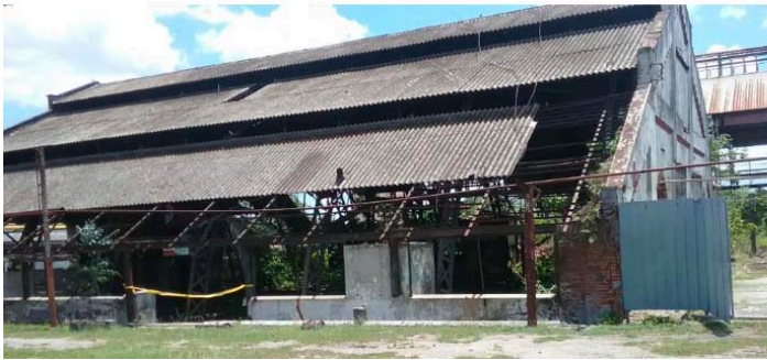
Fig. 20 Bâtiment des machines et des générateurs Source : Archive de Teresa Bilbao
