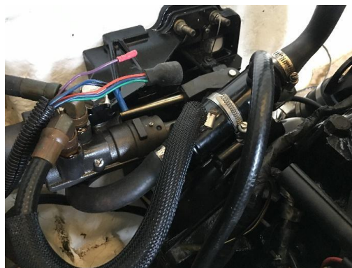
Figura 3.37: Conexão do sistema hidráulico do leme assistido ao motor
