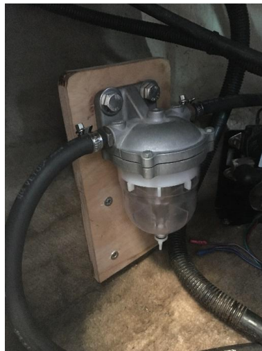
Figura 3.39: Novo decantador da linha de combustível do motor
