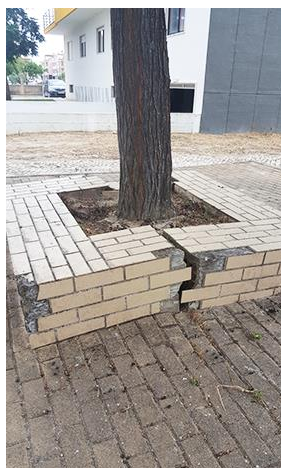
Figura 18 - Pavimento danificado pelas raízes.
