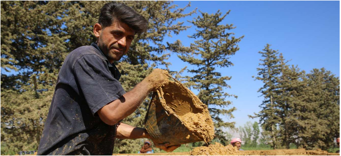
Fig. B-13 : Nayef Izzo posant un lit de mortier lors de la construction des claustras du kiosque à musique Source : Collection Houda Kassatly
