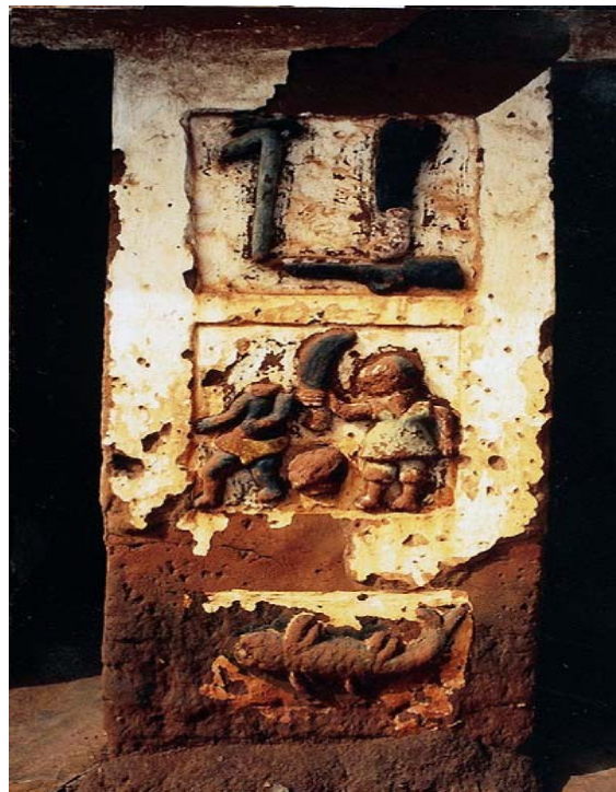
Figure 14 : Décoration architecturale en dégradation Bas-reliefs, adjalala de Béhanzin
