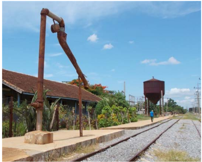
Fig. 3.51 Château d'eau métallique et bras mécanique.
