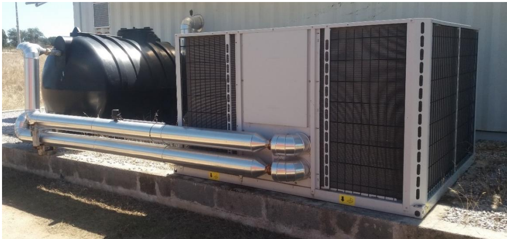
Figura 14 - Chiller e Reservatório
