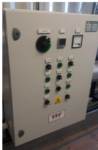
Figura 13 - Painel de controlo da caldeira
