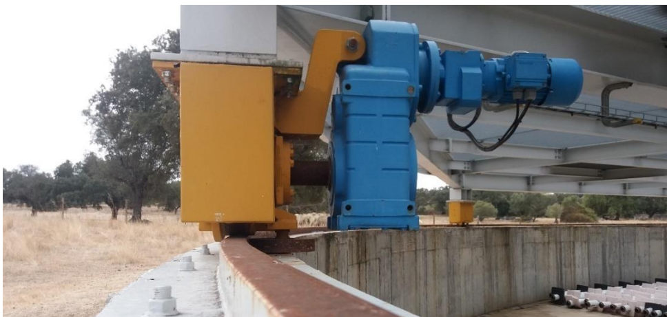
Figura 5 - Apoio móvel com motor
