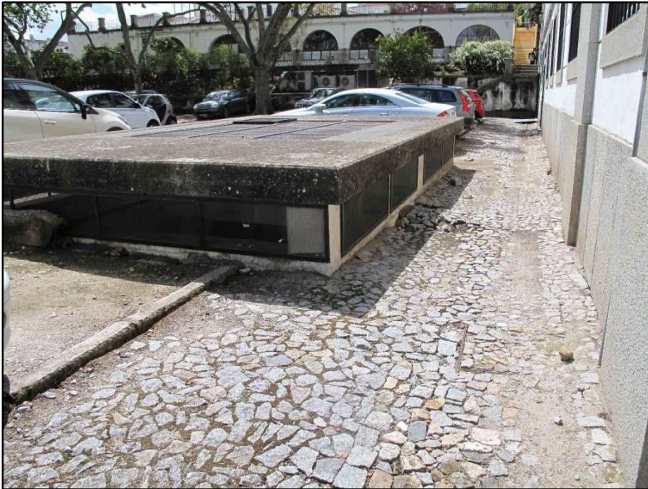
Figura 3. Infraestruturas de climatização do CES (©Leonor Rocha).
