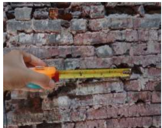
Figure 10. Les briques de tructure du four sont liées l'une à l'autre par la boue mélangée au sable, sans ciment. Source : Auteur
