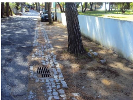
Figura 58 Problemas Encontrados nos Pavimentos - Entre a Calçada e o Betuminoso
