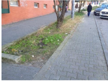
Figura 33 Área Plantada em Mau Estado Junto ao Estacionamento
