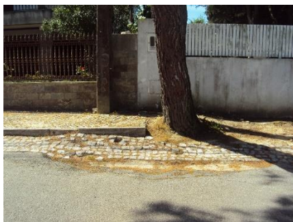
Figura 61 Problemas Encontrados nos Pavimentos – Nos Encontros de Pavimentos
