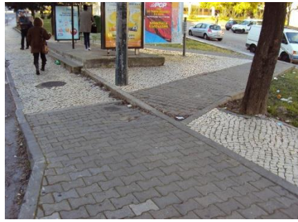
Figura 35 Encontro de Pavimentos Mal Resolvidos
