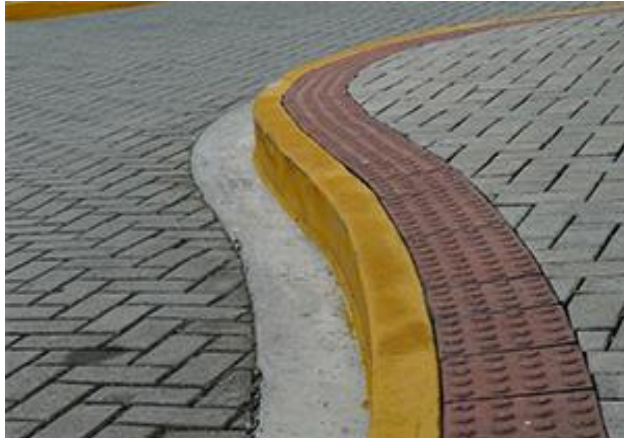
Figura 6 Pavimento Táctil de Alerta
