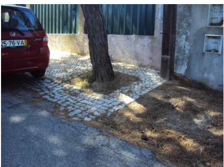
Figura 60 Problemas Encontrados nos Pavimentos – Nos Encontros de Pavimentos
