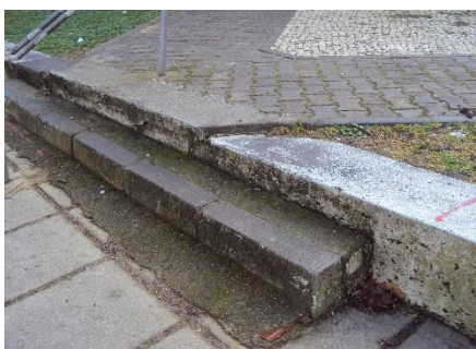
Figura 38 Escadas em Mau Estado
