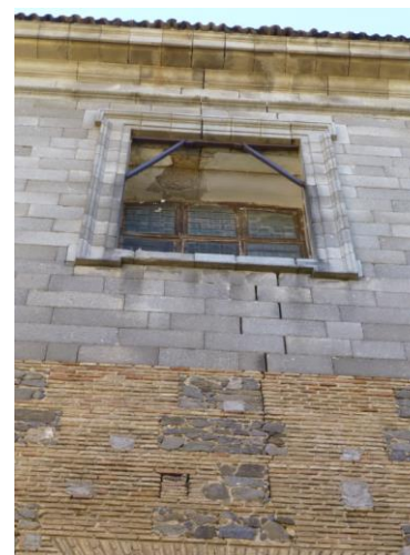
Figura 4. Fractura penetrativa y desplazamiento de bloques de sillería en el muro NW de la torre del crucero. Las caídas de los bloques de sillería del arco de la ventana fueron protegidas por un jabalcón de acero.
