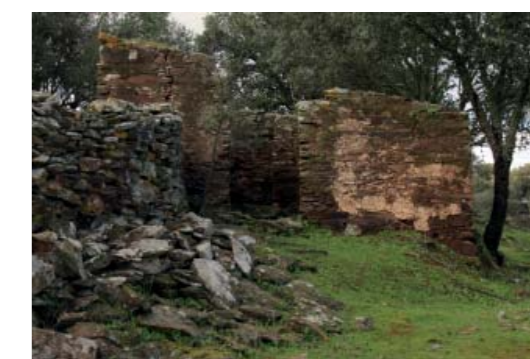
fig. 209 Ruína de um anexo agrícola e muro.
