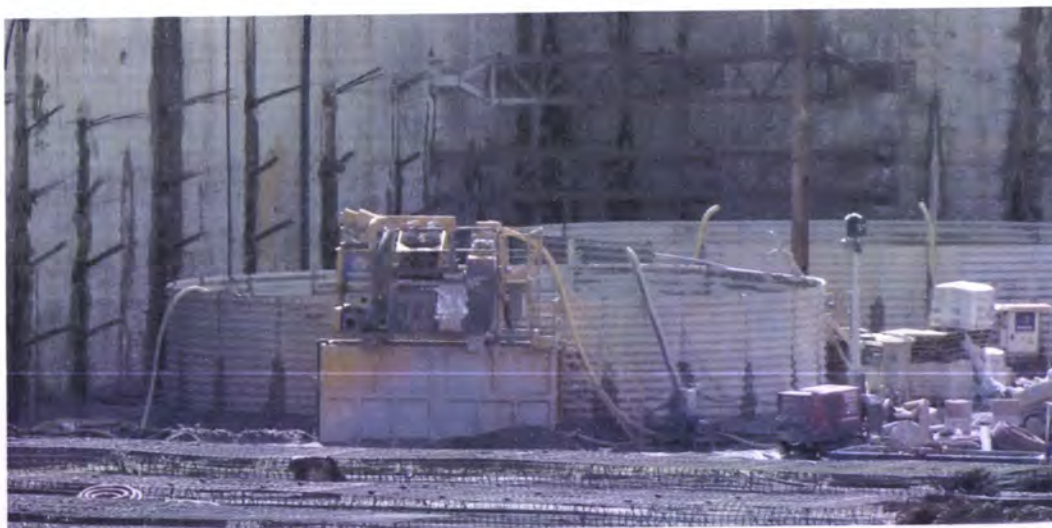
Figura 6.10 - Central de Bentonite com sistema de desarenador.
