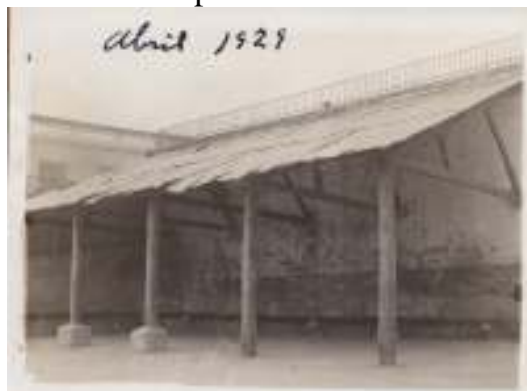
Figura 8: Construção precária no perímetro do pátio em 1929
