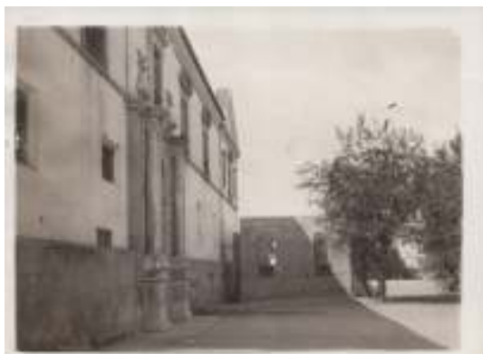
Figura 7: Estrutura em ruína à direita da entrada nobre do claustro
