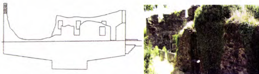
Figure 3: Constatation de l'état de ruine du mur Est
