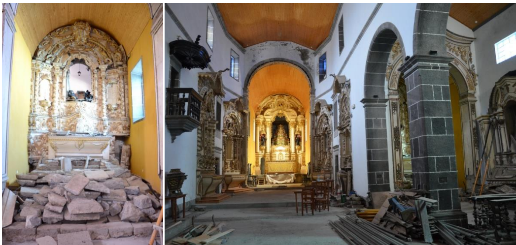
Figura 149 – O período compreendido entre a década de 1950 e o ano de 1994 foi de um processo de completa ruína da igreja de N. a Sr. a de Guadalupe. [Fonte: Duarte Nuno Chaves, 2011/12.]
