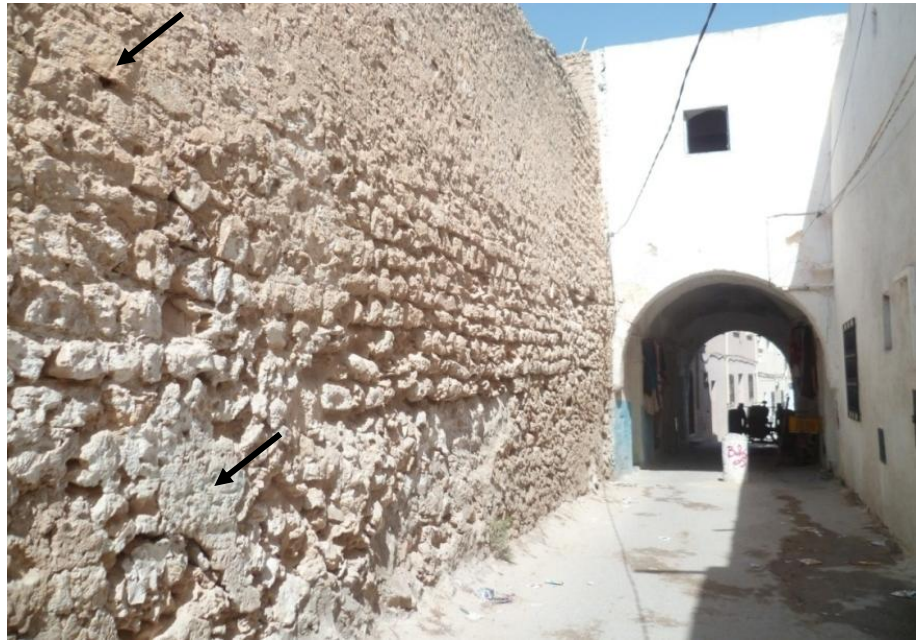
Figure 25: Intérieur d'un mur qui a perdu son enduit. On reconnaît des blocs taillés (indiqués par des flèches) qui correspondent vraisemblablement à un remploi (C. Weslati, août 2014).
