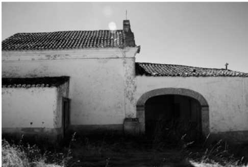
Deformação da cobertura, indicador de movimento de paredes e de enfraquecimento e danos da estrutura de suporte da mesma.
