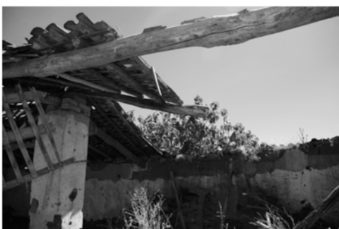
Ruína, queda e danificação avançada da estrutura das coberturas e das telhas tanto o Lagar como da Ermida
