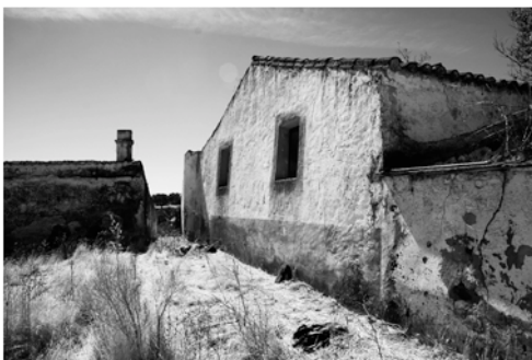
Descolamento avançado e queda do reboco das paredes, provocador de degradação e fissuração das mesmas.
