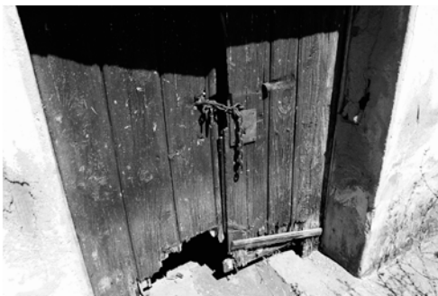
Putrefação das madeiras das portas, vãos, caixilharias e vigas que suportam os mesmos vãos
