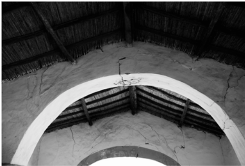
Fissuras indicadoras de rotação nas fundações
