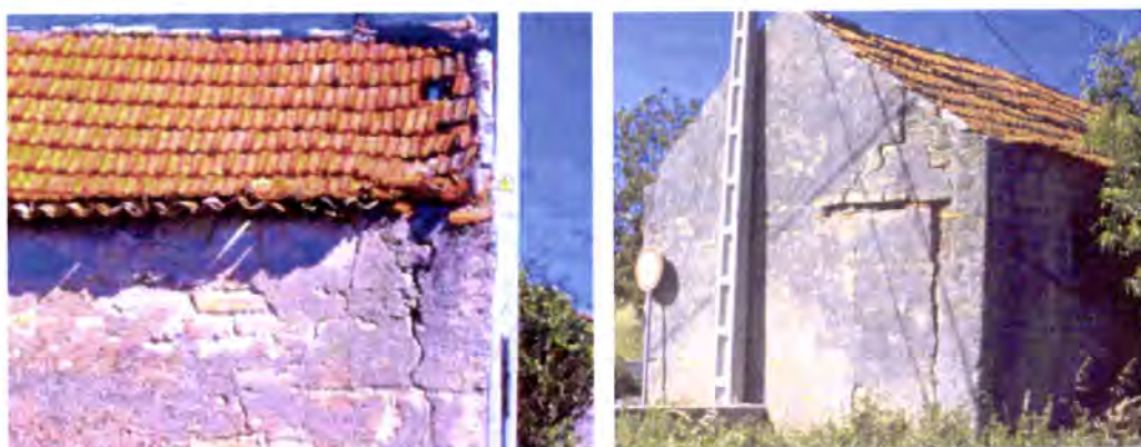
Fotos 11.15 e 11.16 – São Bernardo, Aveiro. Aspectos característicos da falência da cobertura e posterior aparecimento de fendas ao nível superior dos vãos, provocadas por assentamentos diferenciais das fundações e de “fendas de topo”, resultantes de alterações de carga a que as paredes afectadas passaram a estar sujeitas.
