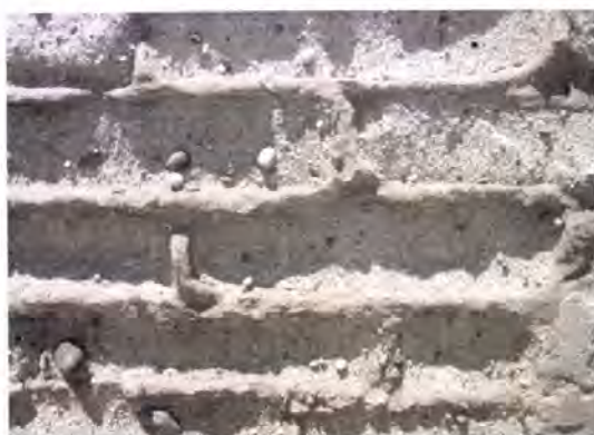
Foto 11.2 – Gafanha da Nazaré, Ílhavo. Erosão diferencial de alvenaria de “adobos de cal” numa parede de habitação promovida fundamentalmente pela escorrência superficial das águas pluviais e devida à variação da natureza dos adobos face às argamassas de assentamento.
