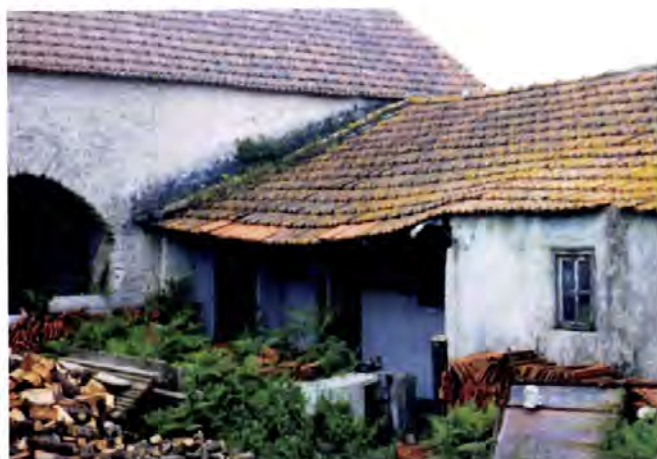
Foto 11.6– Seixo de Mira, Mira. O principal factor de decaimento das casas gandraesas está relacionado com infiltrações de águas pluviais e com os processos de decaimento que induzem nas estruturas em madeira das coberturas.
