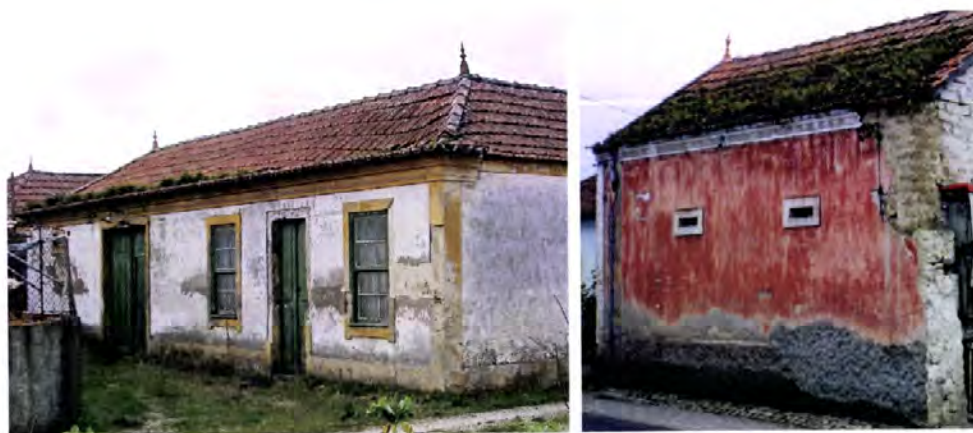
Fotos 11.9 e 11.10 – Gafanha da Nazaré, Ílhavo e Seixo de Mira, Mira. Erosão dos rebocos a meio “pano” devido acção mecânica das águas projectadas pela cobertura cuja inclinação, já anormal do beirado, não é suficiente para projectar as águas pluviais para fora do plano da parede aspecto da colonização biológica severa de uma cobertura.
