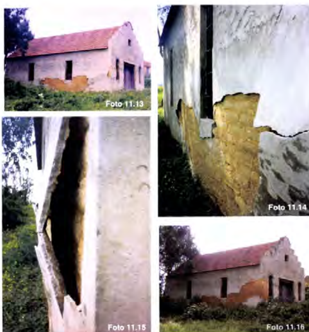
Fotos 11.13, 11.14, 11.15 e 11.16 - Ouca, Vagos. Evolução do decaimento passado um ano (Fotos 11.13 e 11.16). A utilização de argamassas de reboco de natureza muito diferente das alvenarias leva ao colapso do revestimento e à afectação das mesmas.
