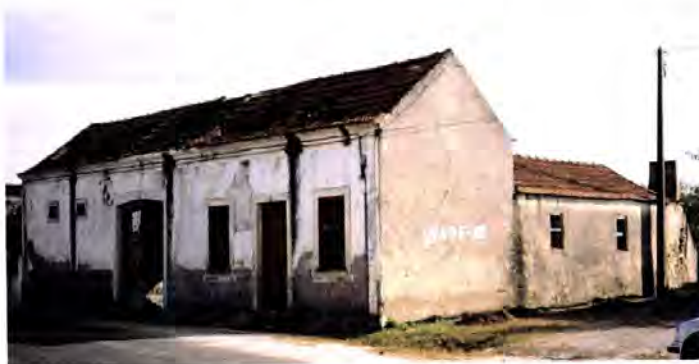
Foto 11.1 – Seixo de Mira, Mira. Decaimento generalizado de uma casa gandraesa já em processo de abandono.
