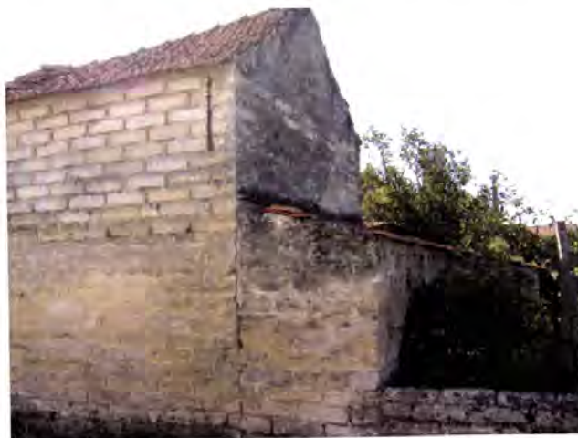
Foto 10.23 – Gafanha da Nazaré, Ílhavo. Colocação de um sistema de barras metálicas de travamento das paredes e aspecto do descolamento de dois corpos adoçados, facilitado pela descontinuidade das alvenarias das respectivas paredes.
