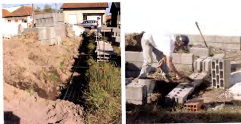
Fotos 10.12 e 10.13 – Gafanha da Nazaré, Ílhavo. Na região, a abertura dos caboucos e a construção das fundações destinadas a edifícios de pequeno porte, construídos por pequenos empreiteiros locais, continuam a fazer-se de acordo com os métodos tradicionalmente utilizados. Apenas mudaram os materiais e o “desenho das casas”.
