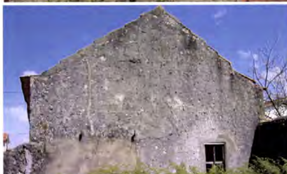
Fotos 10.40 e 10.41 – Gafanha da Nazaré, Ílhavo. Diferenças entre coberturas e fugas, respectivamente do corpo principal e do corpo longitudinal de uma casa gandraesa.
