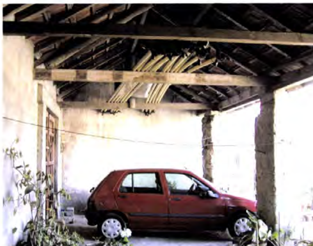
Foto 10.34 – Gafanha da Nazaré, Ílhavo. Solução de estrutura de cobertura travada por barrotes (“linhas”).
