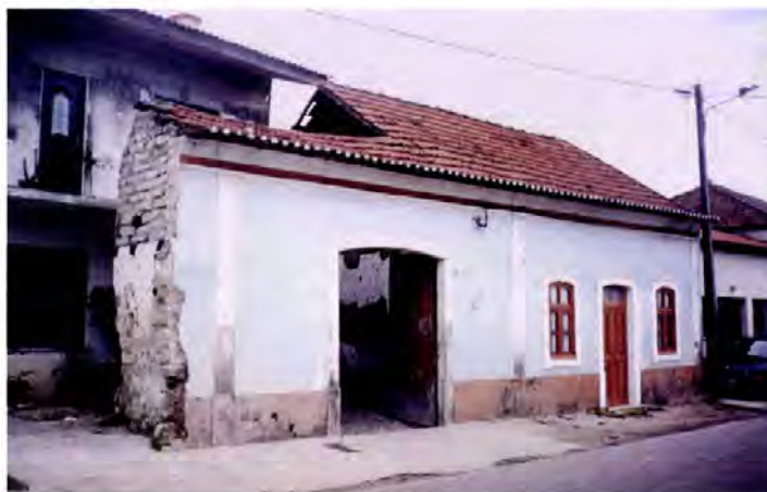
Foto 12.6 – Fonte Angiã, Vagos. A destruição da casa gandraesa em prol de novas construções, corresponde a um processo comum apesar de, contrariamente às expectativas dos proprietários, dele não resultar uma melhoria das condições de habitabilidade, de conforto ou mesmo estéticas, face às preexistentes.
