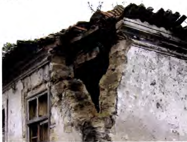
Foto 11.3 – Gafanha do Carmo, Ílhavo. Apesar dos “adobos de cal” resistirem mais à acção das águas que a generalidade das alvenarias de terra, a falência das estruturas de madeira e os esforços transversos que induzem nas paredes, acabam por condicionar o nível de decaimento da casa.
