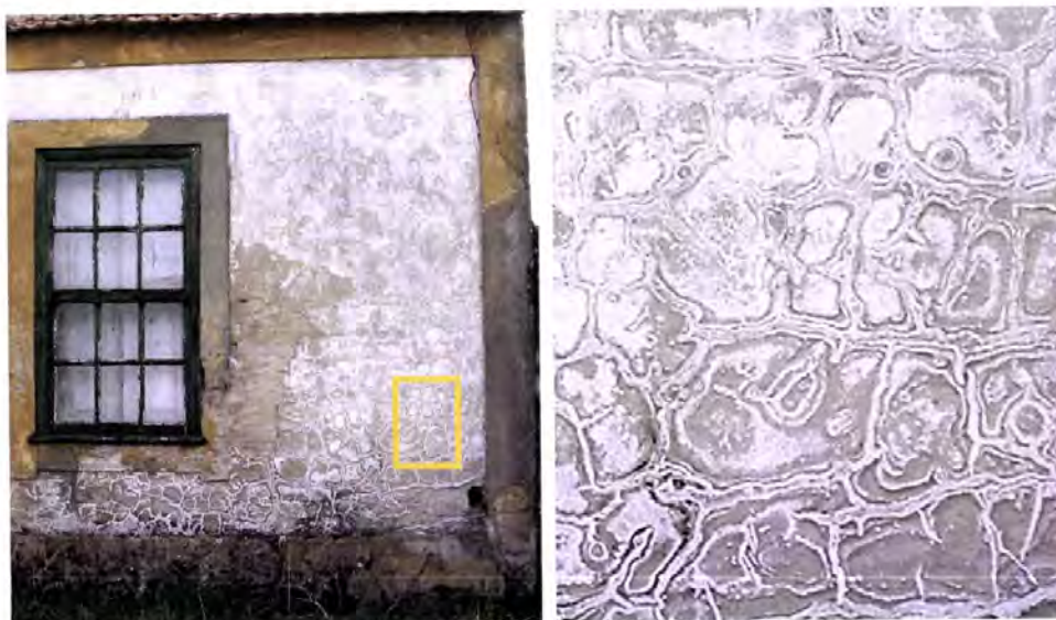
Foto 11.11 e 11.12 (pormenor indicado) - Gafanha da Nazaré, Ílhavo. Microfissuração característica da erosão de rebocos tradicionais de cal, devido à presença de águas por infiltração e capilaridade no interior das alvenarias. Acima do nível do “peito” da janela a generalidade do reboco estava aderente ao suporte.
