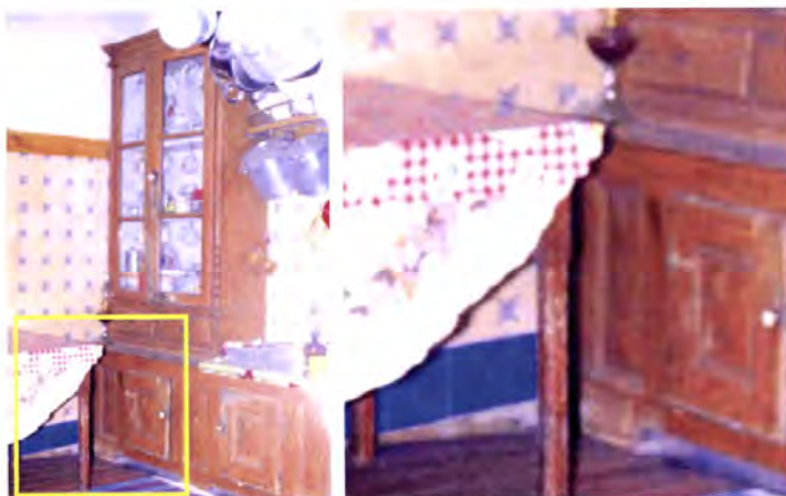
Foto 11.7e 11.8 (pormenor indicado). São Bernardo, Aveiro. Deformação do “solho” de uma cozinha devido à falência do respectivo vigamento promovida por infiltrações ao nível da cobertura, devido à falta de estanquicidade na zona de ligação entre o corpo principal e o longitudinal, associada a fenómenos de capilaridade.
