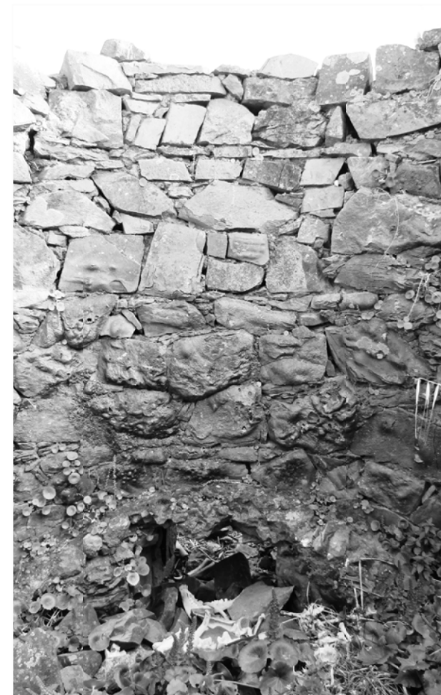
Figura 72: Pormenor do interior do forno da quinta do Moinho, no qual é possível observar o cintel, que sobe por cima da porta de alimentação da caldeira. Castro Marim, 2015.
