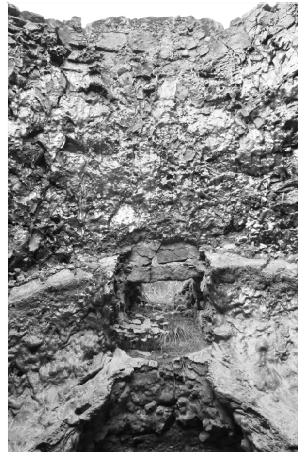
Figura 92: Pormenor do interior do forno do canto Córías, no qual é possível observar as alvenarias revestidas de escorras e o cintel, em parte quebrado, que sobe por cima da porta de alimentação da caldeira. Laranjeiras, 2015.
