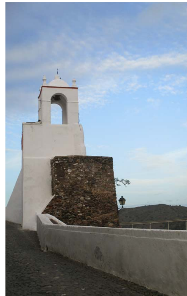
Figura 1: Torre do relógio parcialmente caída, inserida no pano de muralha voltado ao rio Guadiana. Mértola, 2015
