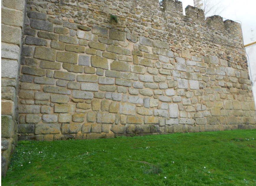
Figura XXXVII – Pormenor do aparelho construtivo das muralhas de Évora, Rua Largo dos Colegiais.
