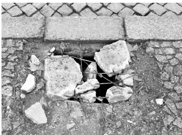
Figura 19 - Tampa de betão armado danificada
