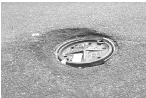
Figura 7 - Tampa de perfil cónico invertida com aro partido devido a assentamento deficiente
