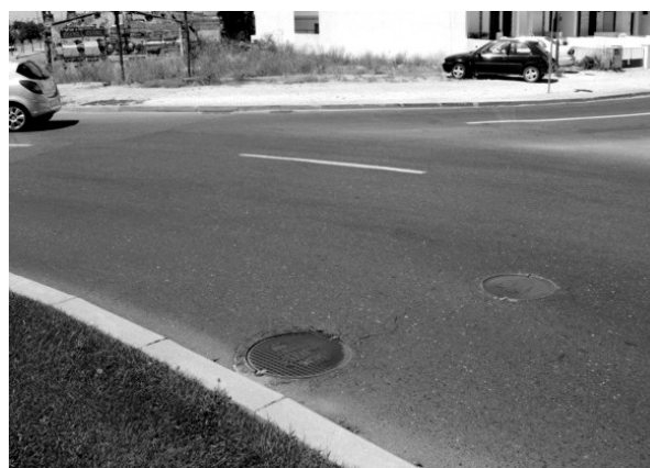
Figura 17 - Desgaste em tampas na Rotunda da Porta de Aviz
