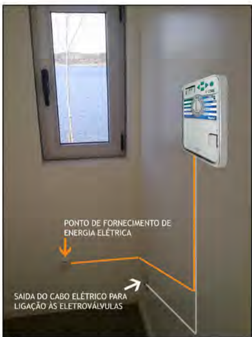
PORMENOR DA INSTALAÇÃO DO CONTROLADOR INTERIOR NO POSTO DE SOCORRO E VIGILÂNCIA
