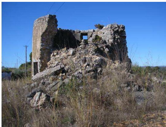
Ilustração 40 – Vista do estado de ruína - moinho MV034.
