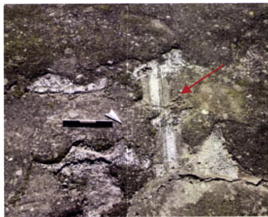
Fig. 26 – Detalhe da reparação do pavimento em mosaico com uma argamassa hidráulica ( frigidarium ).
