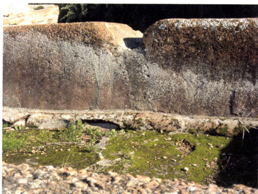
Fig. 23 – Interior da cisterna: observa-se a colonização biológica sobre o revestimento - patine biológica de coloração branca -
