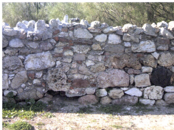
Fig.35 - Parede situada no extremo Noroeste das TRT com reconstruções ao nível da base e do topo.
