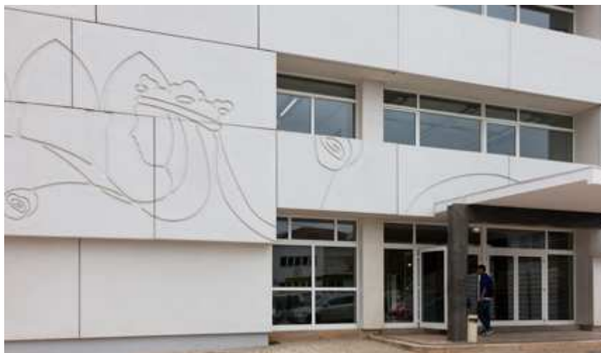
Imagem 22 - Escola Secundária Rainha Santa Isabel depois da Intervenção pela empresa Parque Escolar (Foto do Autor)
