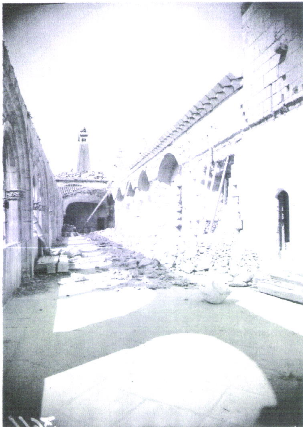
106. Claustro de D. Dinis: demolição do piso superior junto ao Dormitório (Arquivo da DGEMN)
