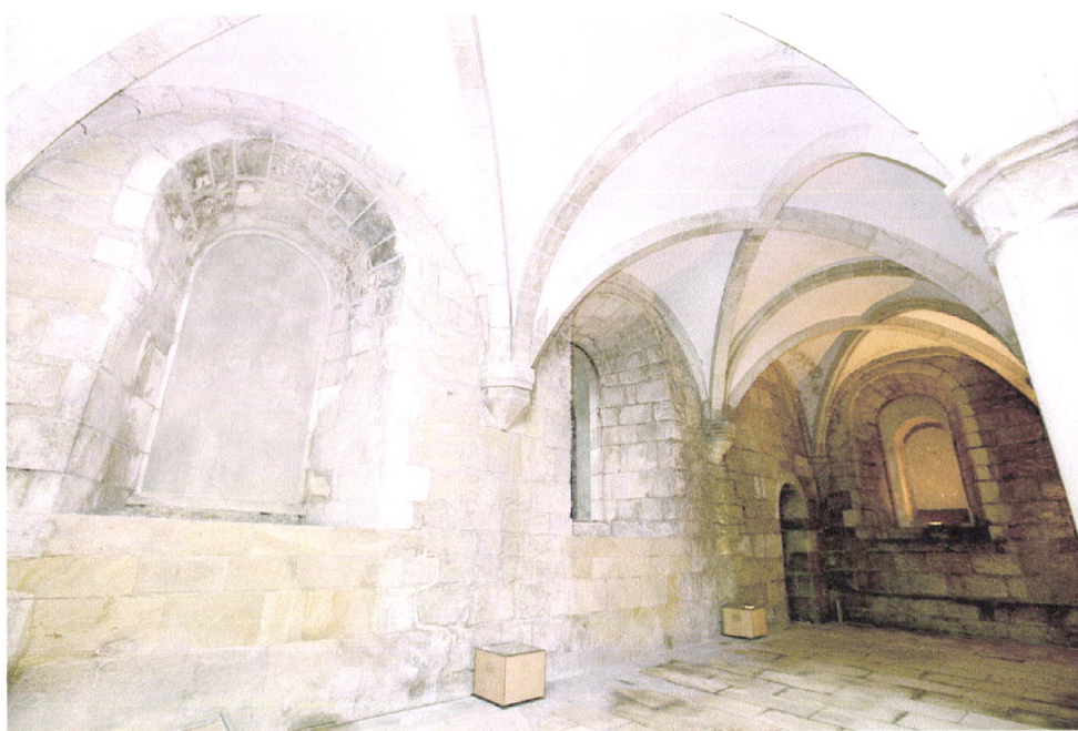
54. Sala dos Monges: vãos de comunicação com a Cozinha entaipados (estado actual)
