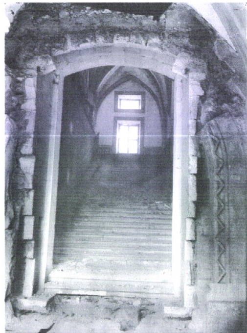
114. Dormitório: remoção do vão da porta de acesso ao claustro (Arquivo da DGEMN)
