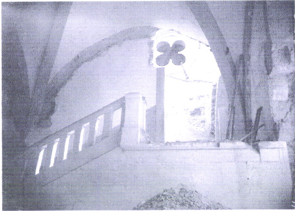
126. Dormitório: demolição da escada junto da parede do transepto (Arquivo da DGEMN)
