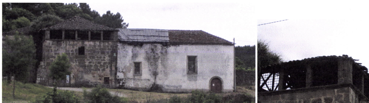
Figs. 4.28 e 4.29 – Sernancelhe: Mosteiro da Ribeira. Alçado norte da igreja e pormenor do mirante.
