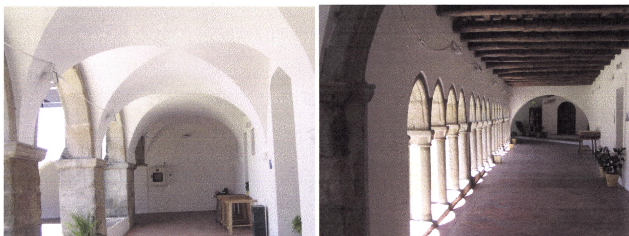
Figs. 3.73 e 3.74 – Portalegre: Mosteiro de Santa Clara. Galerias do piso térreo cobertas por abóbadas e por estrutura de madeira onde apoia um piso de tijoleira.
