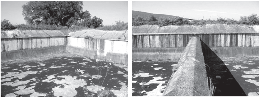
Figs.32 e 33 – Interior dos tanques de aprovisionamento de águas pluviais.
