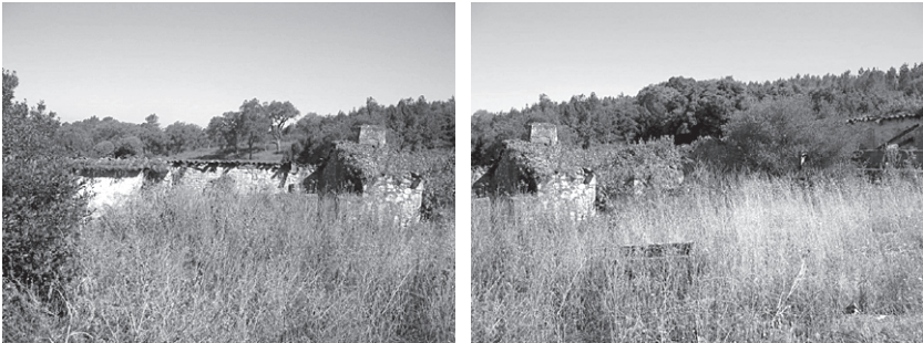
Figs. 19 e 20. Fotografias dos antigos estábulos, em estado de ruína.
