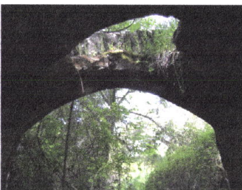
Fig.19 Desabamento do arco central. (Dezembro 2003)
