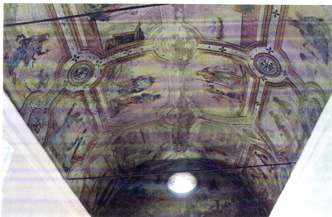
Santa Clara do Sabugueiro - Arraiolos: aspecto da abóbada com fissuração central; fig. 117 a 118
