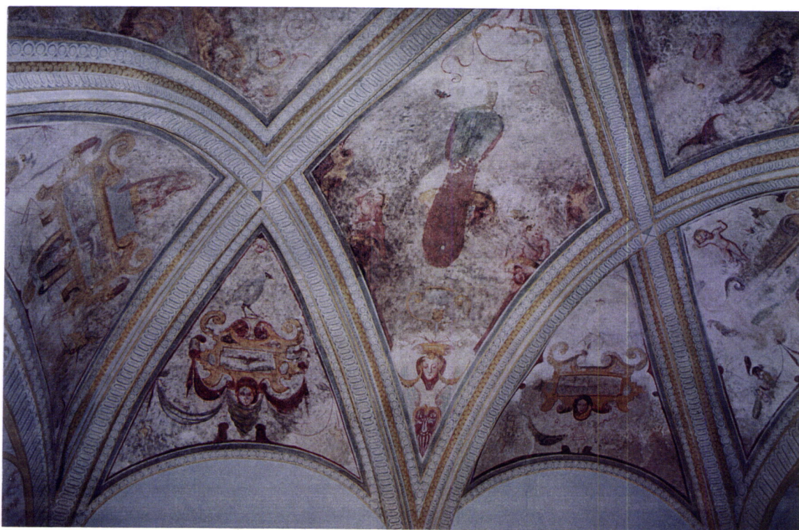
Palácio dos Condes de Basto – Évora Fig. 13 e 14 – Salão Principal – infiltrações e manchas de humidade no tecto
