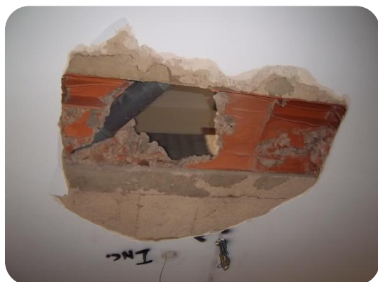
Figura 54 - Danos causados na laje
