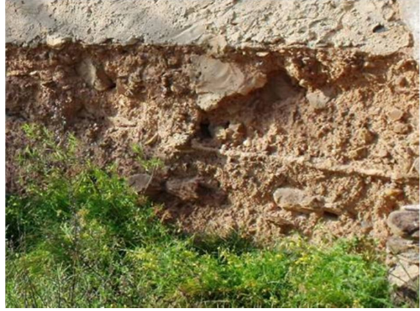
Figura 6.34 - Novo pormenor da erosão em paredes de taipa
