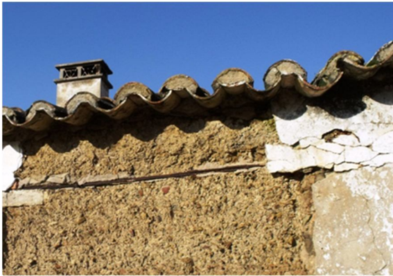
Figura 6.43 - Corrosão da cinta existente, embebida no reboco
