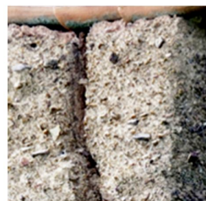
Rotura em cunhais
