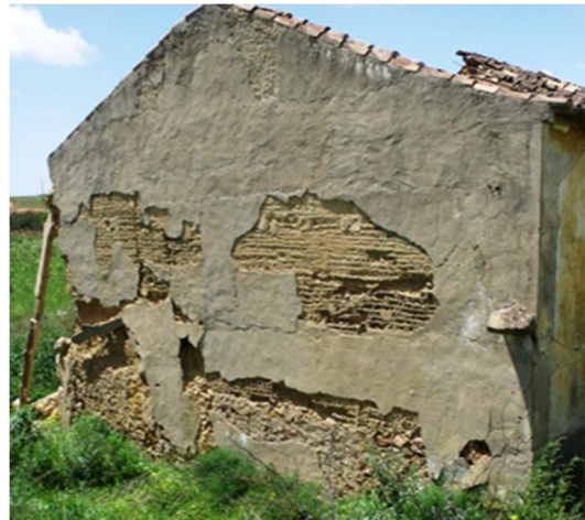
Figura 6.46 - Pormenor do destacamento do reboco
