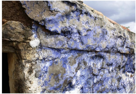
Figura 6.44 - Corrosão da cinta colocada pelo exterior das paredes
