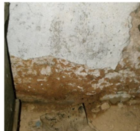
Degradação do reboco
