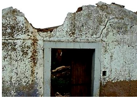
Figura 6.38 - Fissuração diagonal a partir dos vãos
