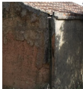
Rotura em cunhais
