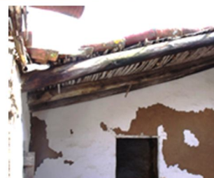
Colaps o parcial da cobertura
