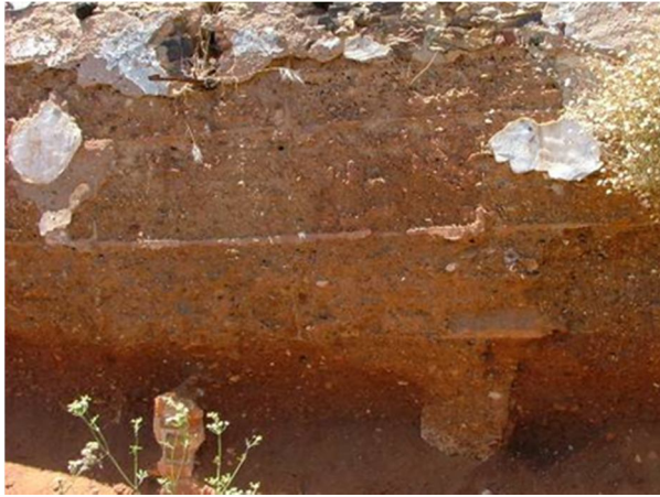
Figura 6.33 - Erosão da parede de taipa devido à exposição aos agentes atmosféricos
