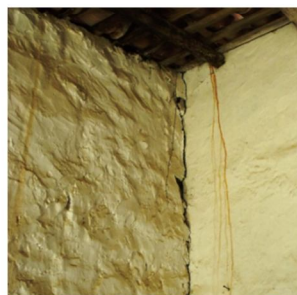
Rotura em cunhais
