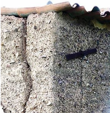
Figura 6.36 - Fissuração por destacamento entre paredes ortogonais.
