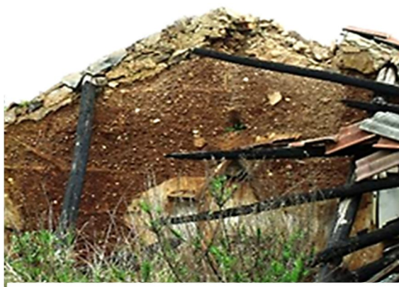
Figura 3.2 - Aspecto da taipa após ocorrência de incêndio
