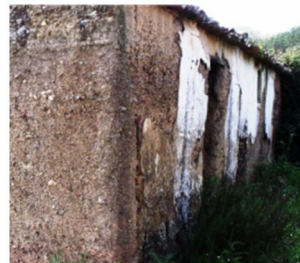
Degradação do reboco
