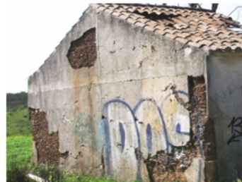
Degradação do reboco
