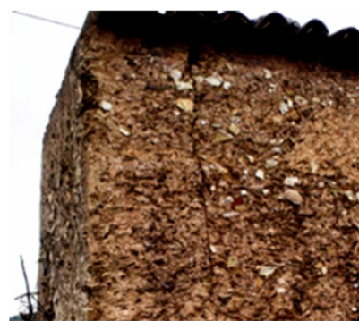
Rotura em cunhais
