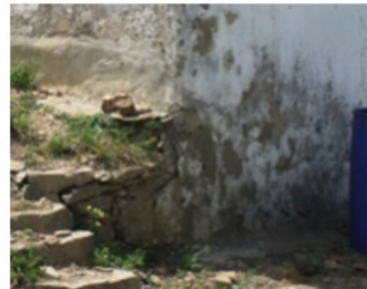
Degradação do reboco
