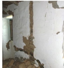
Degradação do reboco
