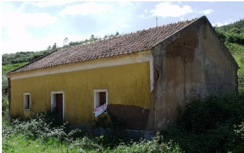
Figura 5.5 - Construção em taipa com um piso, revestida a reboco de cal, com caição a cor
