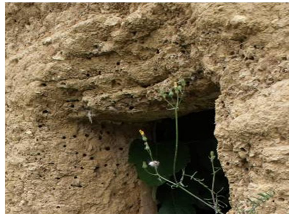
Figura 6.42 - Ataque de insectos no lintel de reforço em madeira e zona envolvente
