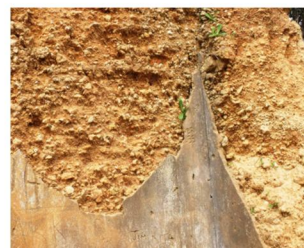
Degradação do reboco
