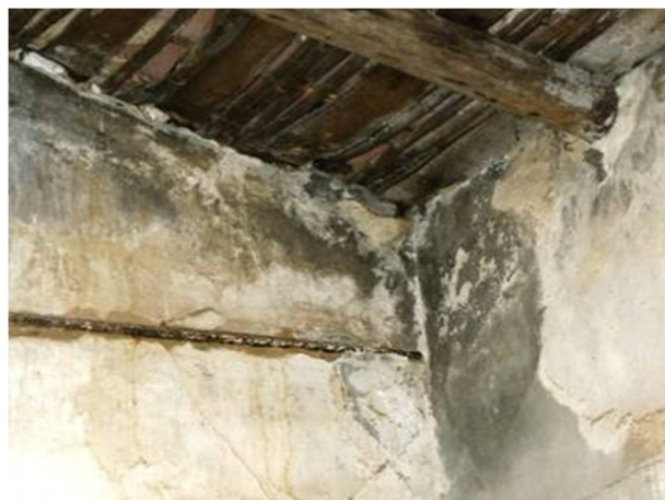
Figura 6.35 – Escorrência de água dos telhados
