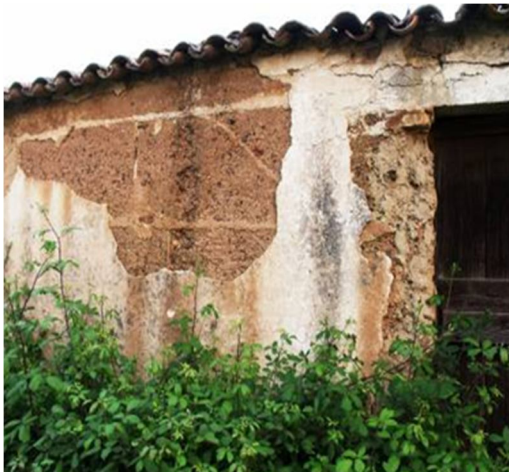
Figura 6.45 - Destacamento do revestimento em reboco
