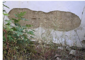
Degradação do reboco
