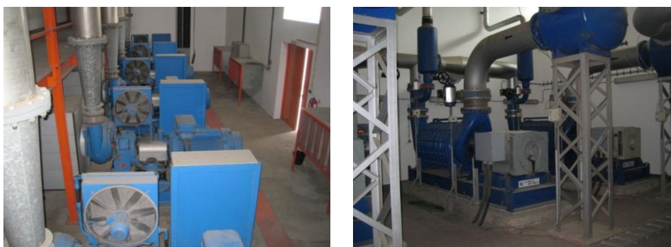
Figura 14 – Pormenor de sobrepressores dos tanques de arejamento
