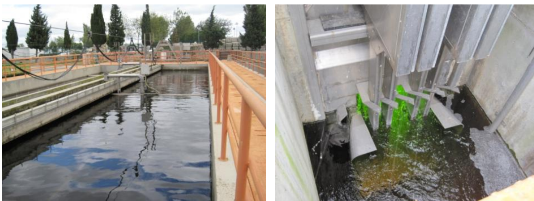
Figura 15 – Pormenor de sistemas de filtração e desinfeção UV
