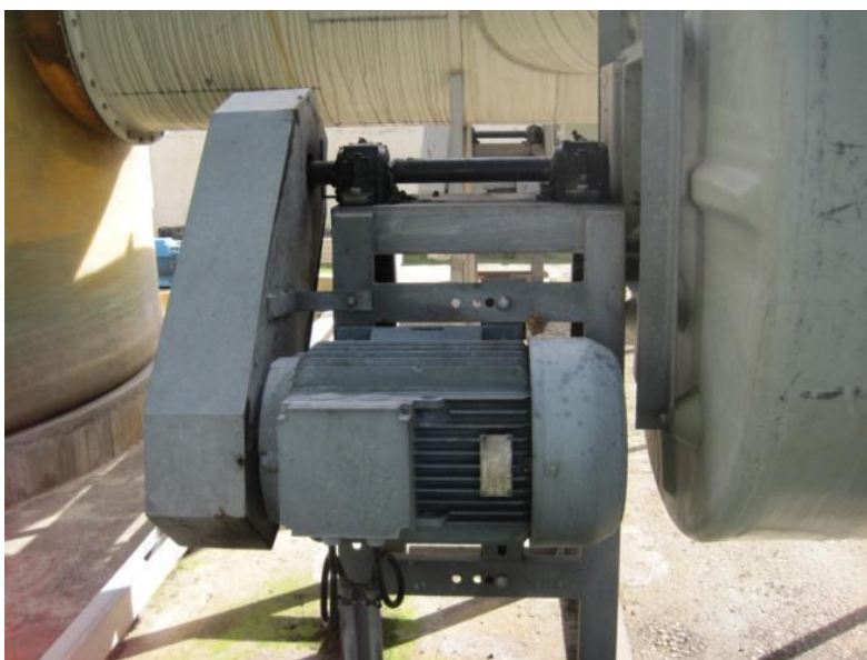
Figura 29 – Pormenor de um motor do sistema de desodorização numa ETAR
