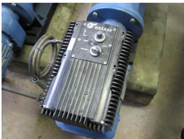
Figura 26 – Detalhe de um motor elétrico com VEV existente numa ETAR auditada
