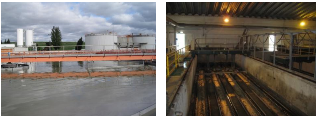
Figura 13 – Detalhe dos sistemas de decantação primária
