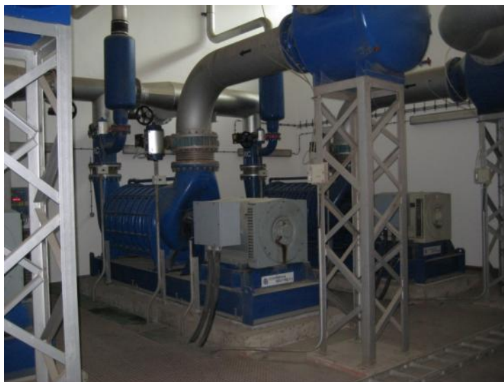
Figura 25 – Aspeto dos sobrepressores existentes numa ETAR auditada
