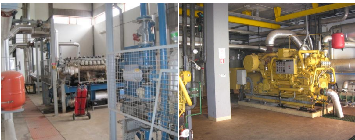
Figura 17 – Pormenor de sistemas de cogeração
