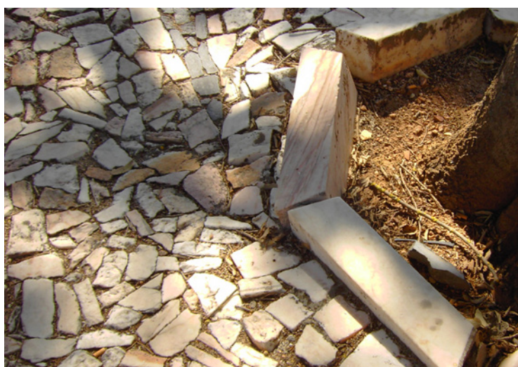
Figura 71. Caldeira e calçada levantadas.
