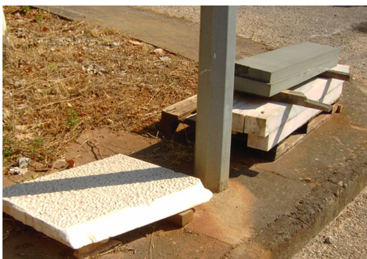
Figura 34. Estado de conservação dos pavimentos.
