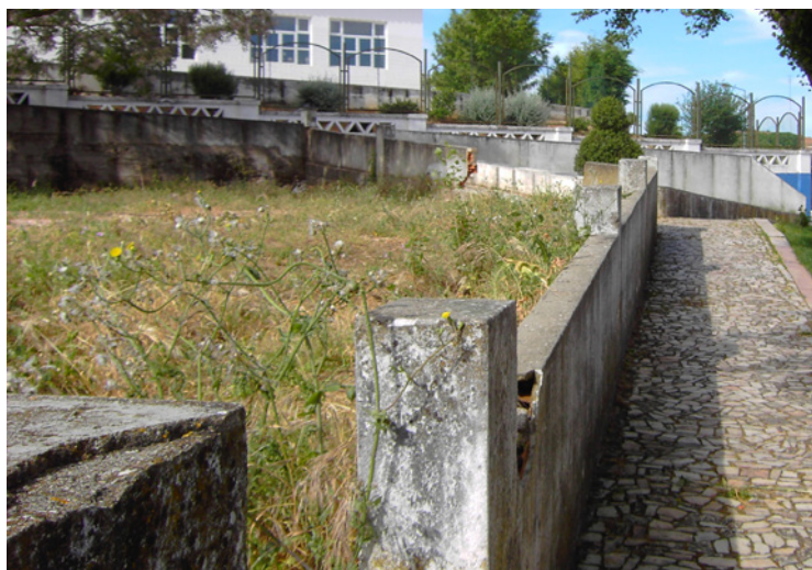
Figura 19. Estado de abandono do terreno adjacente e degradação dos muros.
