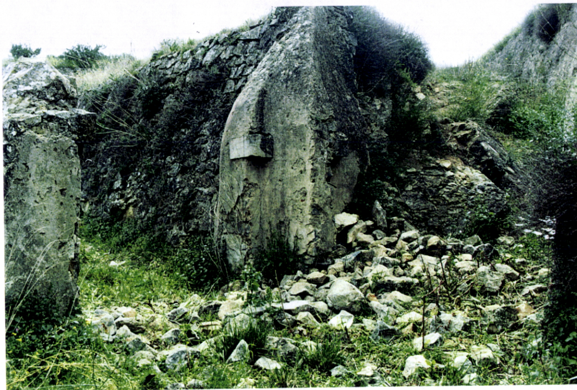
Fig. 98 – Fosso - desmoronamento do muro
