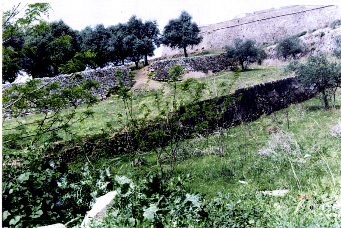
Fig. 90 – Fosso – desmoronamento do muro (aqueduto enterrado)
