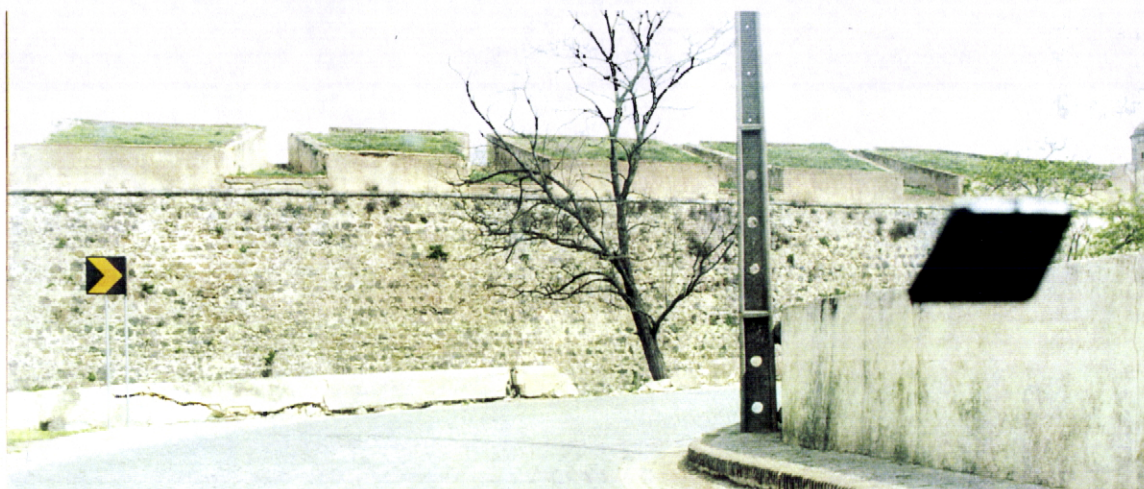
Fig. 100 – Fosso – desmoronamento do muro; árvore debilitada
