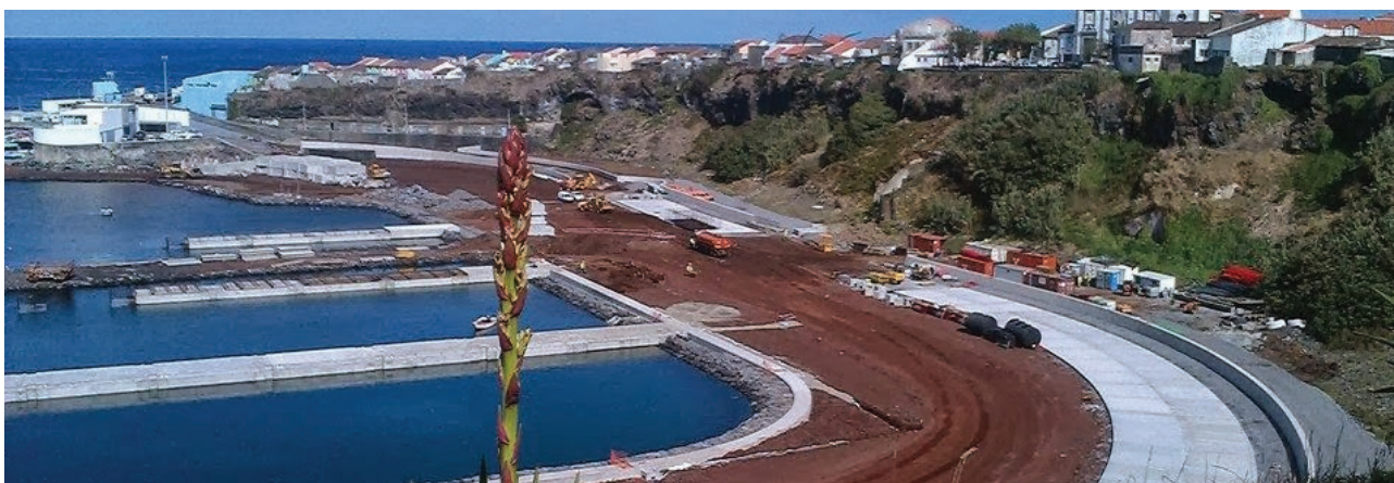
Figura 25 - Construção do novo Porto Marítimo de Rabo de Peixe e vista sobre o talude a intervir.
