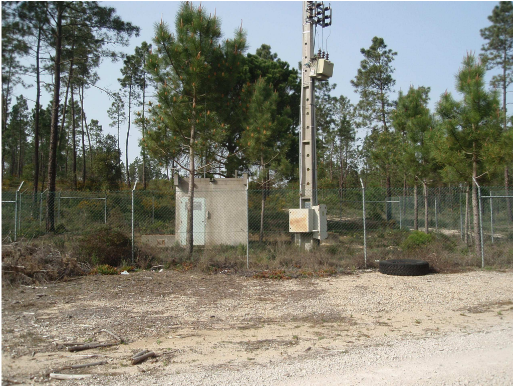
Figura 42: Aspecto geral da captação PS3
