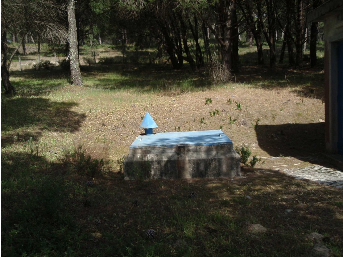
Figura 12: Aspecto geral da captação JK7
