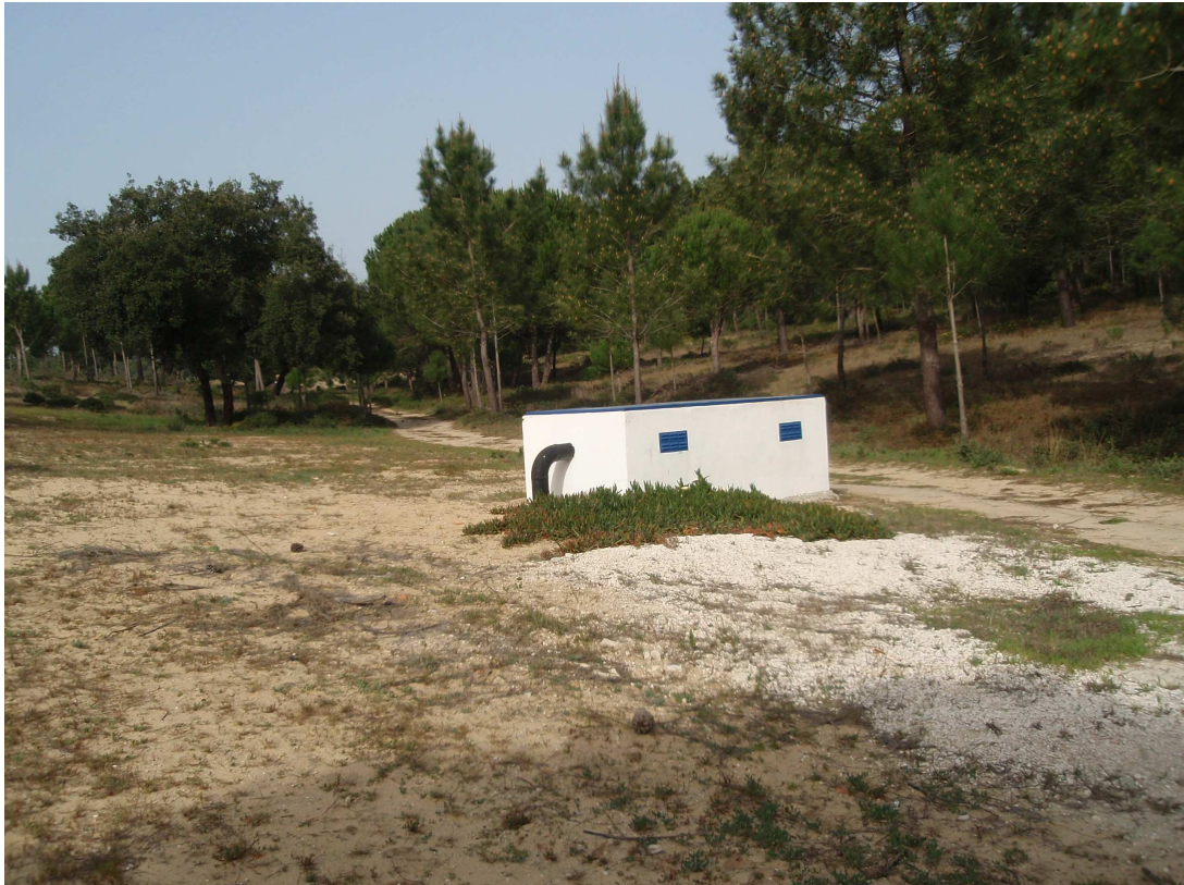
Figura 52: Aspecto da captação RA5
