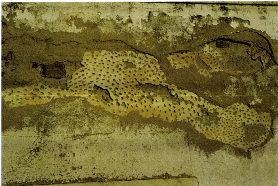
Fig. 38 - Convento do Carmo de Vidigueira. Parede da “sacristia velha”. Sobre um fina camada de barramento , a qual se apresenta picada, foi sobreposta argamassa e bocadinhos de tijolo para formar uma nova camada de reboco. Sobre a verga de uma porta, em cantaria de mármore, o reboco está saliente em relação ao plano da verdadeira pedra. Esta técnica demonstra a intenção de proteger as superfícies pétreas, numa época antecedente à sobrevalorização do material pedra
