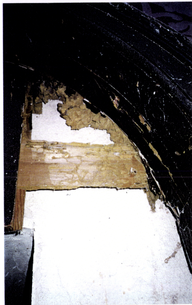
Fig. 94 - Convento do Carmo de Vidigueira. Verga e ombreiras da porta de acesso ao púlpito - ataque de térmitas
