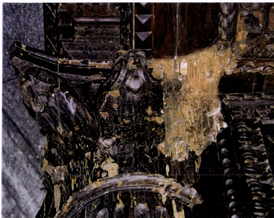
Fig. 92 – Convento do Carmo de Vidigueira. Coluna do retábulo renascentista - supressão de componentes no capitel por acidente
