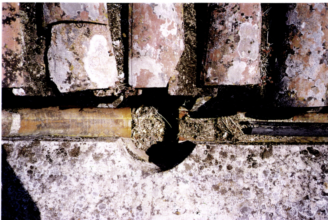
Fig. 63 - Convento do Carmo de Vidigueira. Canaletes e entrada para um dos tubos de queda na cobertura da igreja. Note-se a quantidade de matéria orgânica acumulada no receptáculo dos canaletes, tornando-os ineficazes
