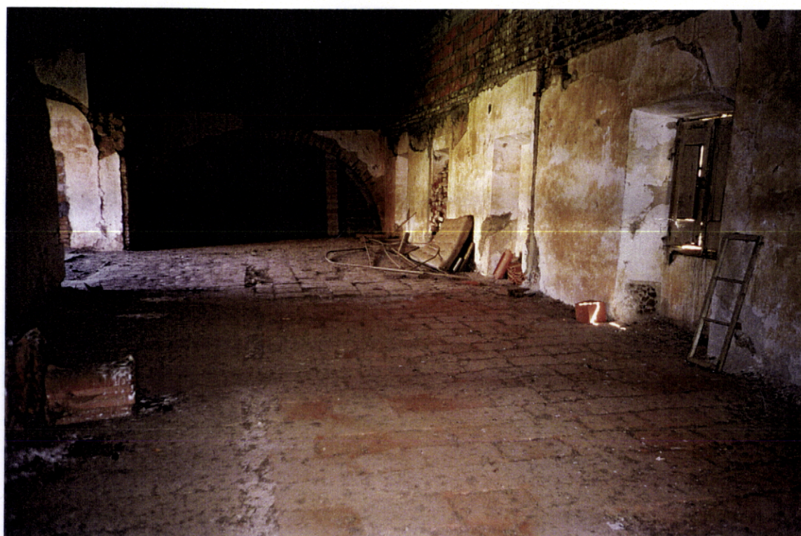
Fig. 73 - Convento do Carmo de Vidigueira. Antigo dormitório e biblioteca. O pavimento deste espaço chegou a receber directamente as águas pluviais, quando a cobertura era ineficaz
