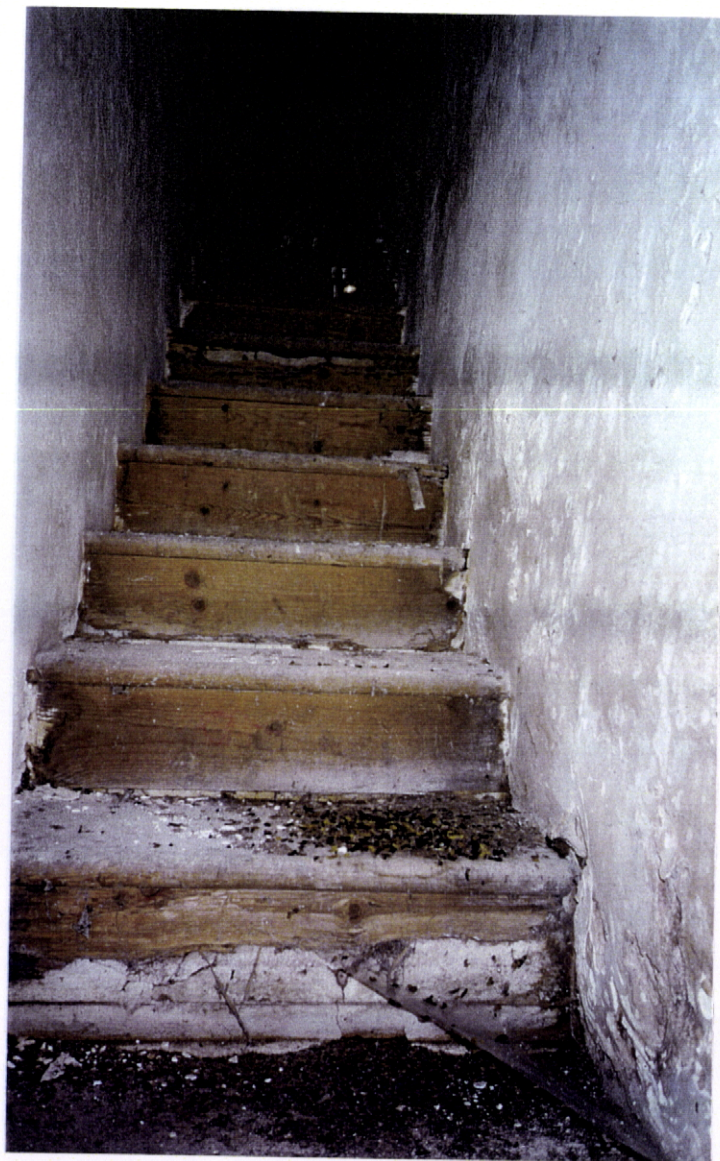
Fig. 99 - Convento do Carmo de Vidigueira. Escadas de acesso ao púlpito - ataque de
