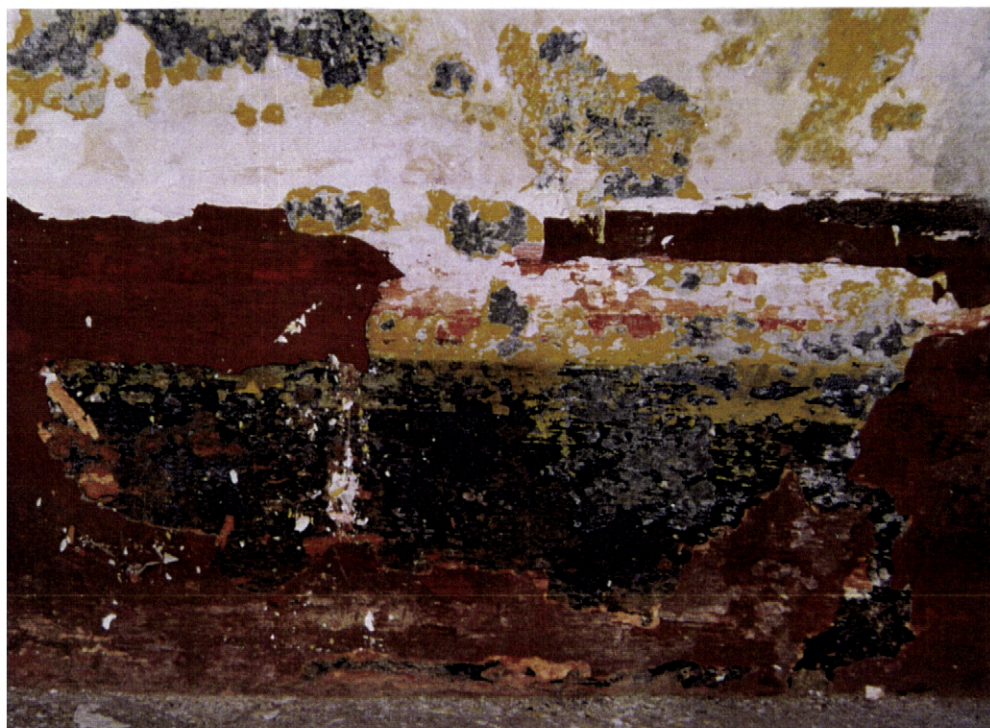
Fig. 90 - Convento do Carmo de Vidigueira. Claustro, ala sul, parede orientada a norte - cal empolada. As últimas camadas de tinta (a vermelho-cor-de-barro) são do tipo pelicular
