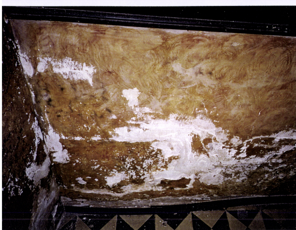
Fig. 89 – Convento do Carmo de Vidigueira. Vestíbulo - tinta empolada junto à janela. Esta parede tem uma floreira encostada do lado exterior
