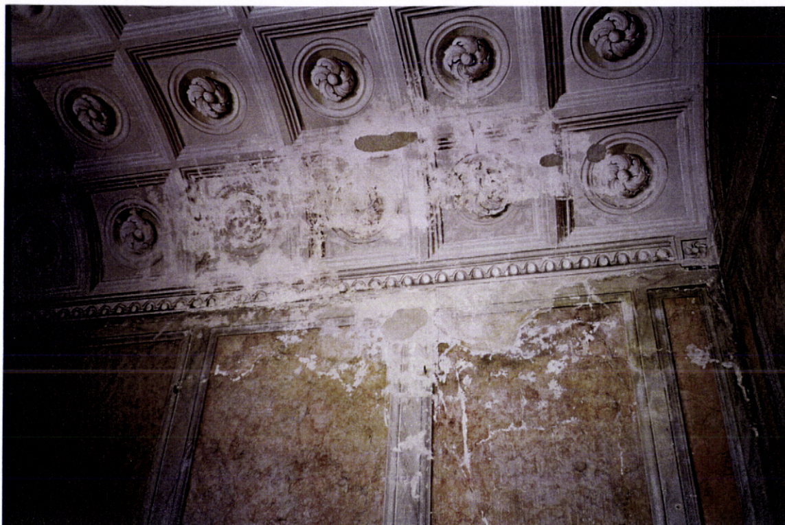
Fig. 72 - Convento do Carmo de Vidigueira. Vestíbulo - abóbada e parede; incidência da humidade no lado direito devida à retenção das águas pluviais
