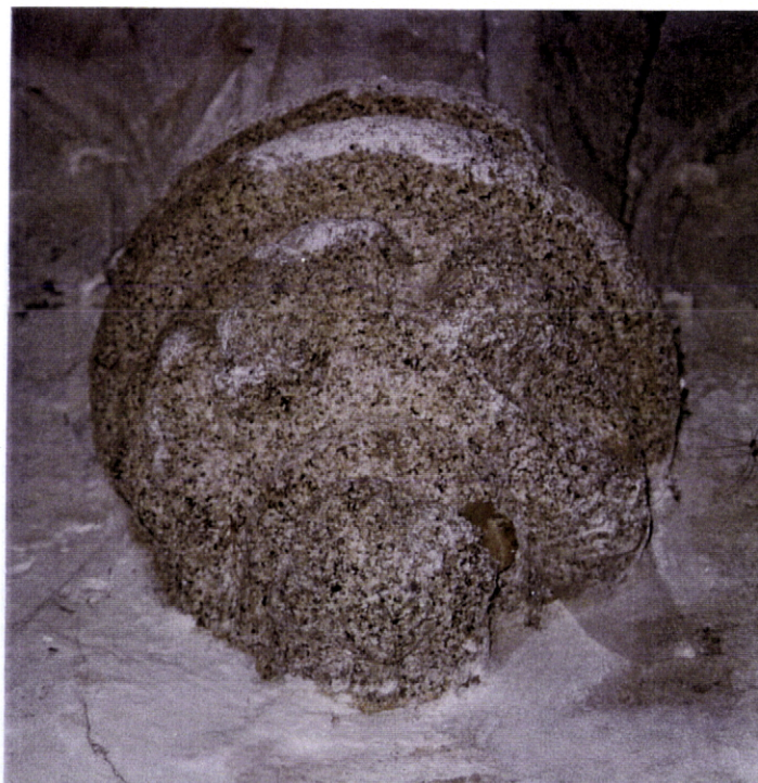
Fig. 101 - Forte grau de arenização numa mísula de granito
