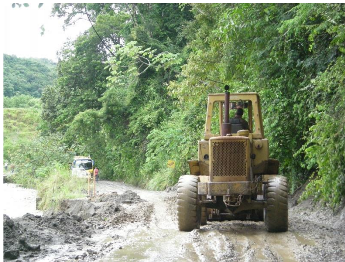
Figura 1. Labores de contingencia ante un derrumbe sobre una carretera rural, causado por lluvias intensas (Foto: Diego Soler-Tovar).
