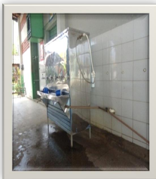
Figura 04 – Vazamento do bebedouro
