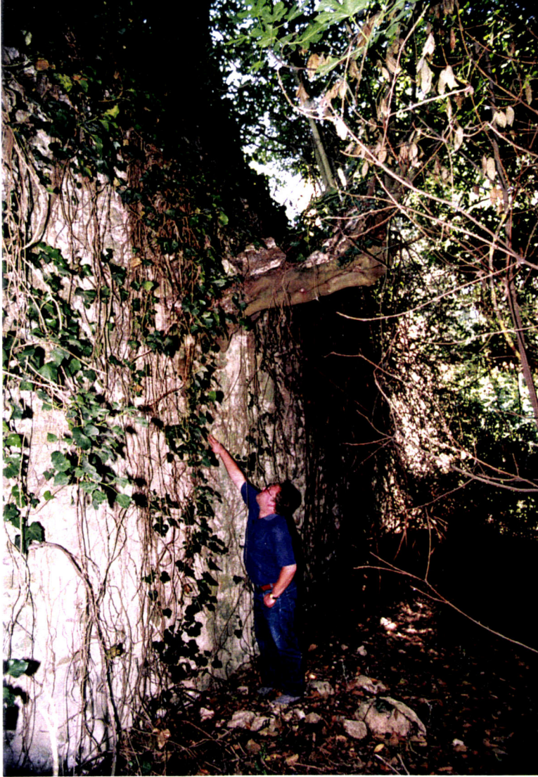
Fotografia 73 Pormenor da mura- lha da Horta dos Frades degradada pela vegetação.
