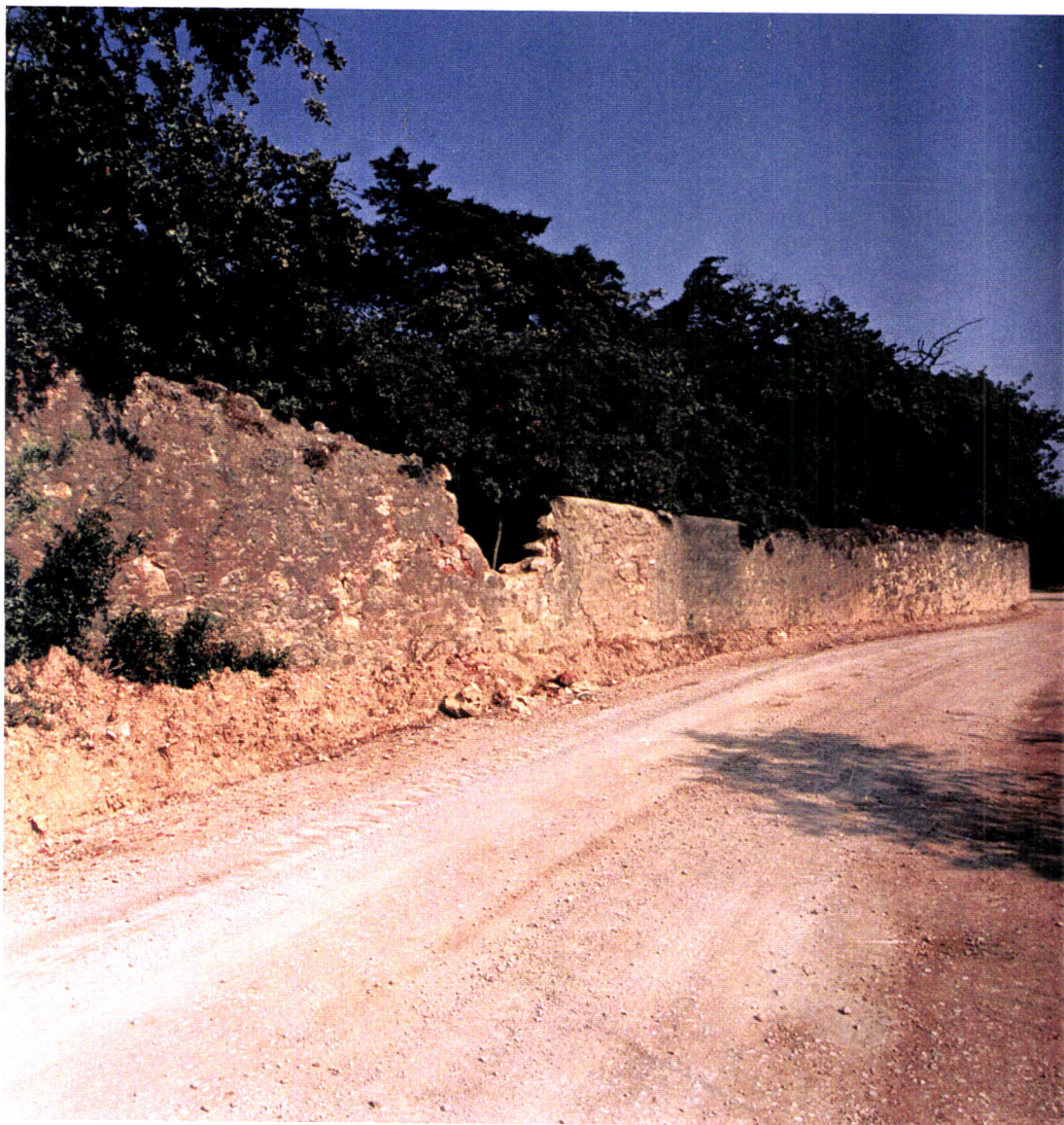
Fotografia 61 Pormenor de degradação de um trecho do muro da Cerca.
