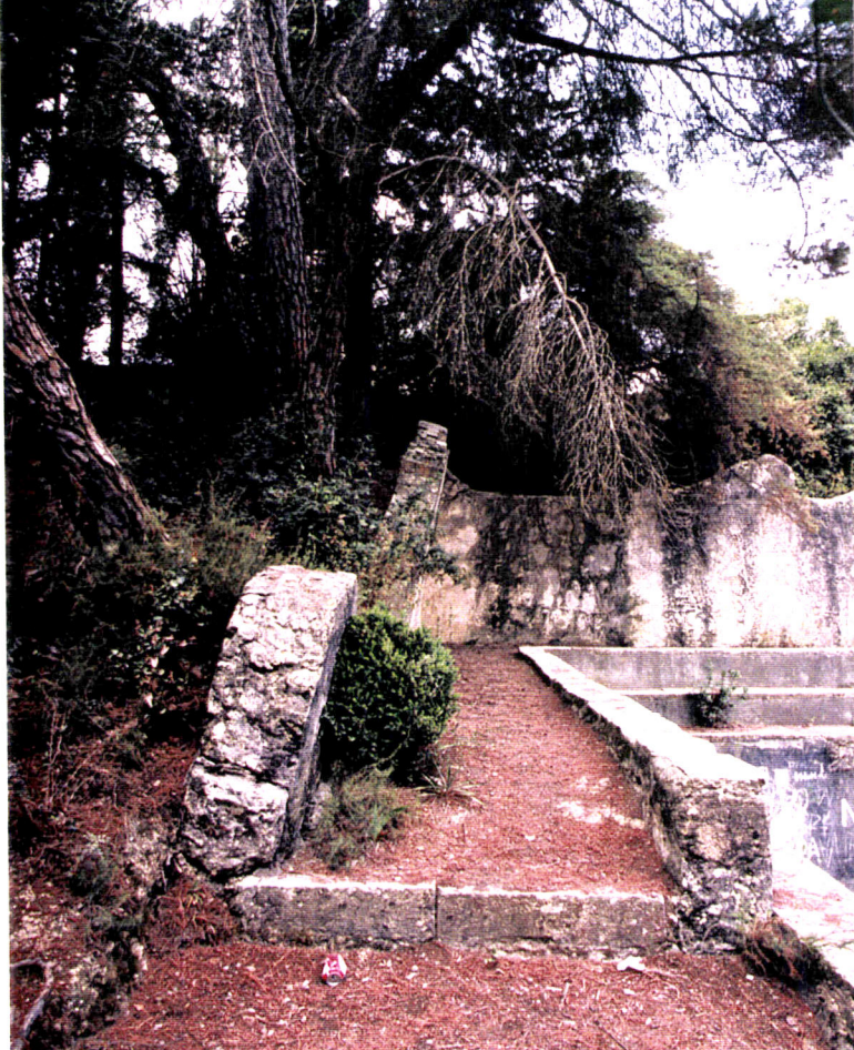
Fotografia 50 Tanque da Cadeira d`El Rei. Muro ameaçando ruína.
