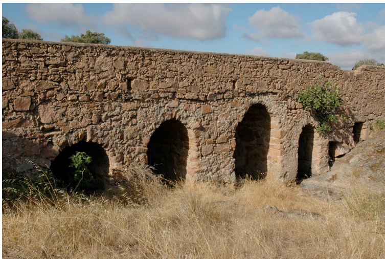
Via XIV: Barbacena (Elvas), ponte que poderá ter reconstruído uma antecessora romana, em zona onde foram encontrados miliários e uma epígrafe funerária.
