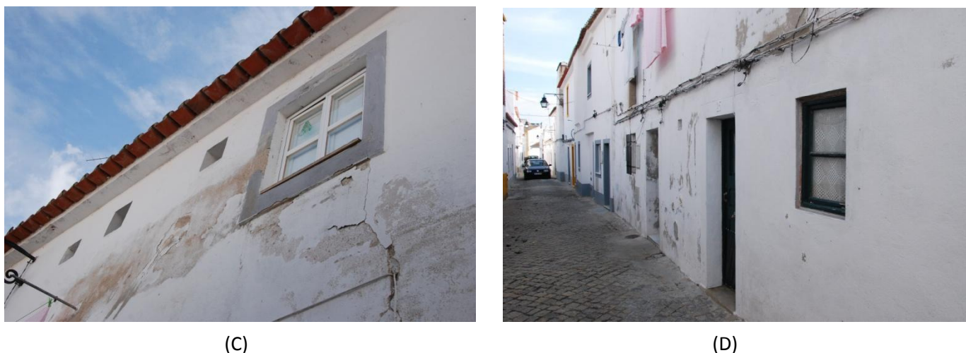
Figura 29: (A) Vista geral da Travessa das Contreyras nas imediações do edifício em estudo; (B) Fachada do edifício; (C) Pormenor de caixilharia do vão envidraçado e degradação do reboco exterior 1º andar; (D) Rés-do-chão caixilharias e degradação do reboco.
