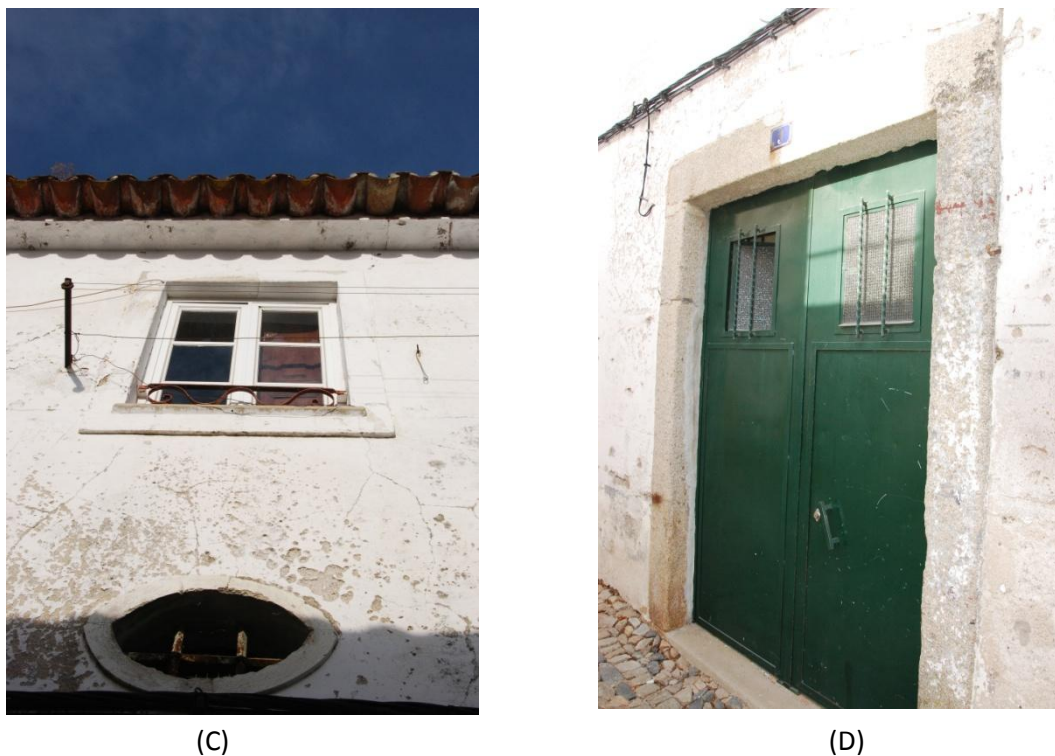
Figura 27: (A) Vista geral da Travessa da Bota nas imediações do edifício em estudo; (B) Fachada do edifício; (C) Pormenor de caixilharia do vão envidraçado e degradação do reboco exterior; (D) Porta do n.º9 com permeabilidade ao ar não controlada
