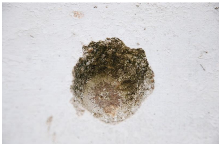
Figura 33: Degradação do reboco existente na parede exterior do edifício permite estabelecer uma espessura aproximada.
