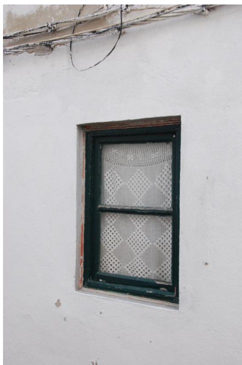
Figura 34: Pormenor da caixilharia de madeira existente na fachada do edifício com cortina interior e vidro simples.
